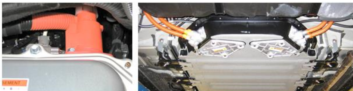
Kuva 12. Korkeajännitekaapelin liitin ajoneuvon konehuoneessa ja korkeajänniteakusto sekä – kaapelit ilman kotelointia auton alustassa.
