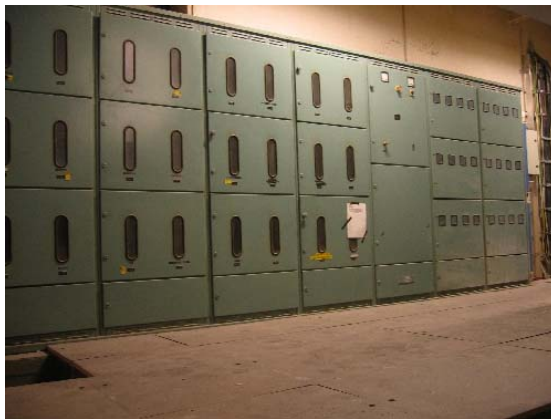
Kuva 2 Pääkeskus V1 (ST216)
