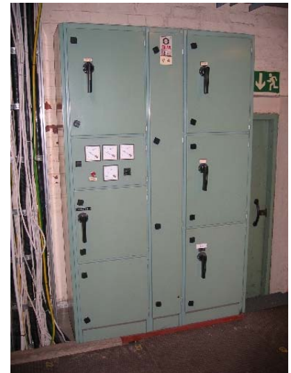
Kuva 3 Pääkeskus V4 (ST207)
