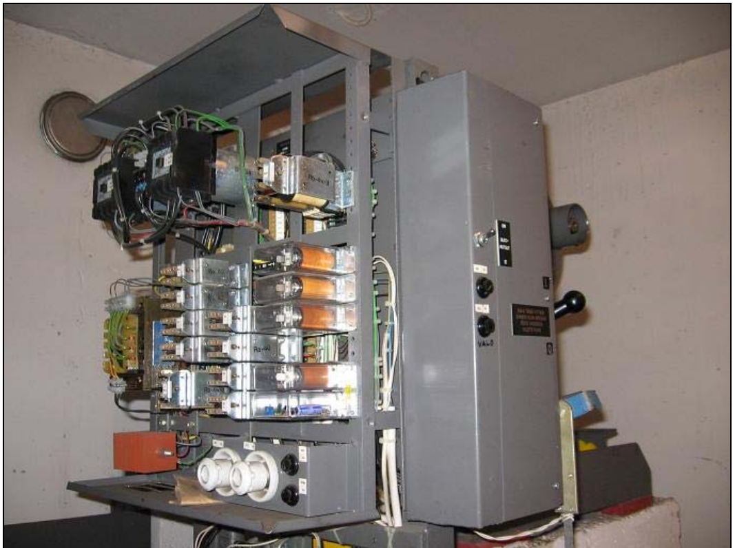
Kuva 12 Valmet Schlieren -hissin ohjauskeskus
