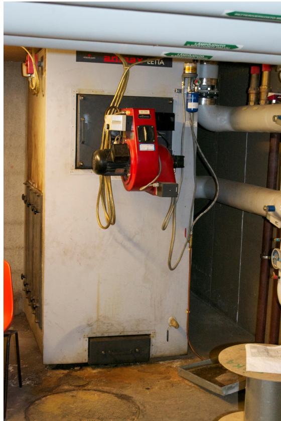
Kuva 15. Heinävaaran koulun öljykattila. (Kuva: Janne Pakarinen.)
