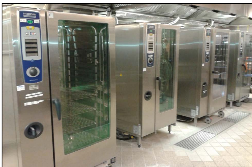
KUVA 1 Tays Keskussairaalan ravintokeskuksen kypsennyskeskuksia
