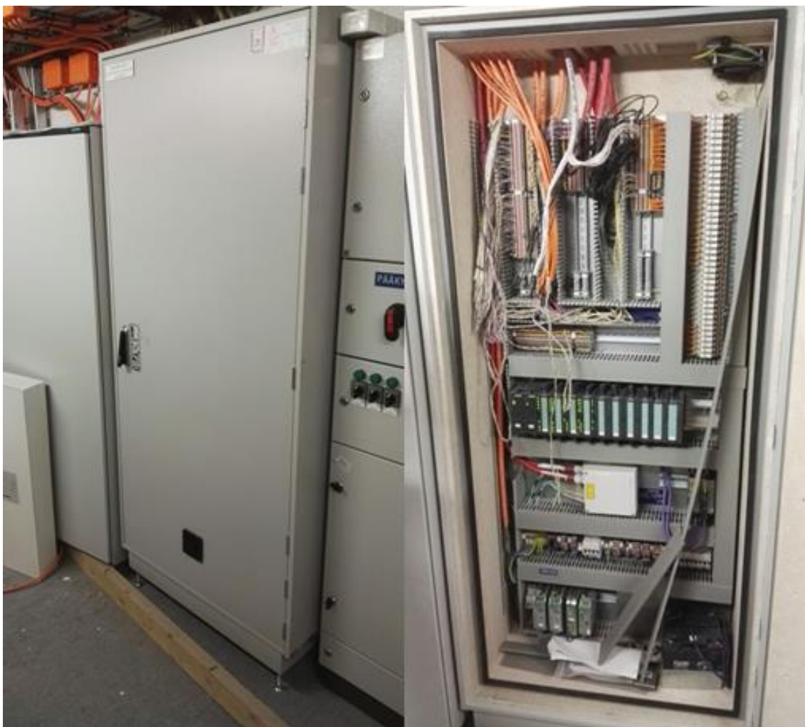
Kuva 3. 60 minuuttia palon aikana toimiva turvajärjestelmän teholähde asennettuna samaan tilaan muiden sähkökeskusten kanssa.
