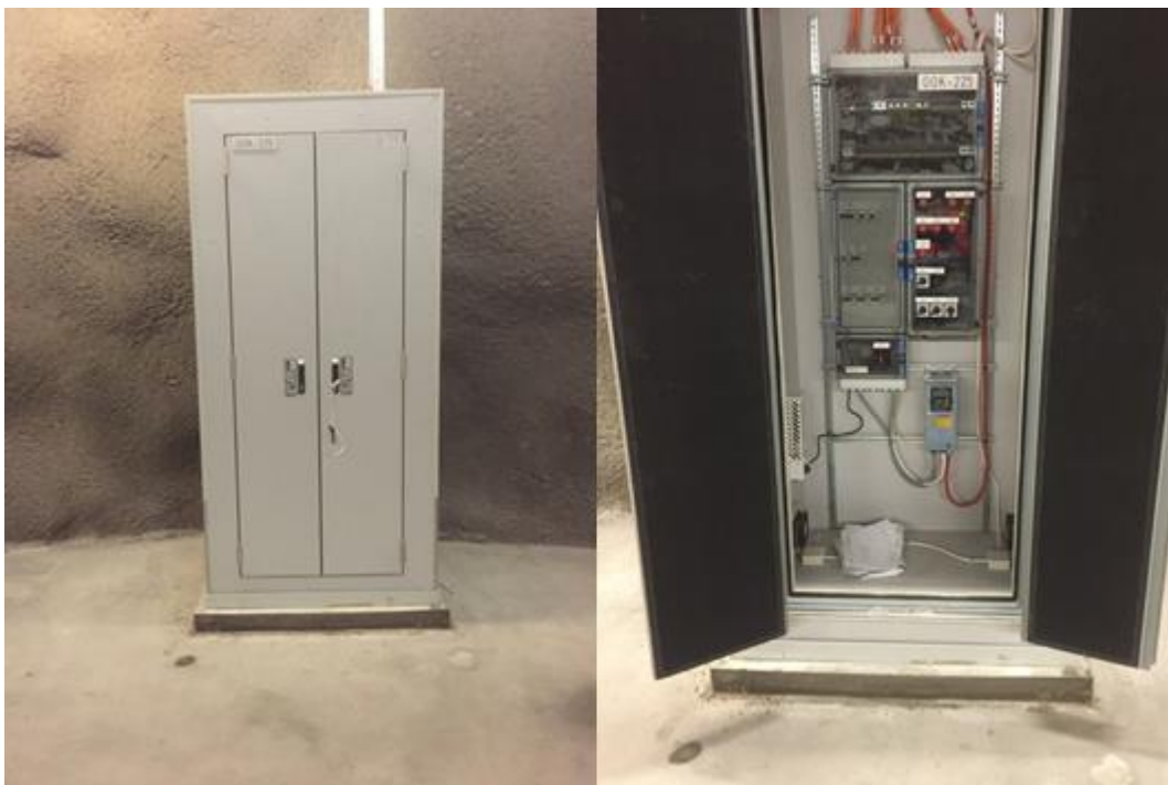
Kuva 4. 90 minuuttia palonaikana toimiva turvajärjestelmän teholähde asennettuna rautatie-tunneliin.
