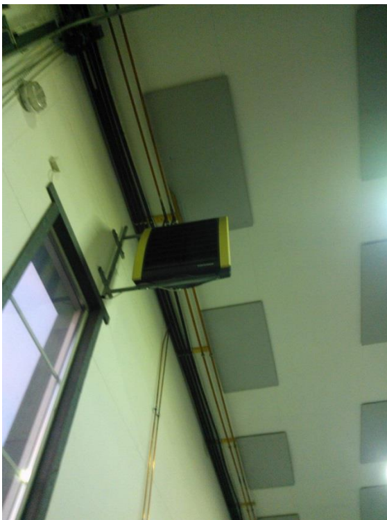
Kuva 10. Hallin lämmitykseen käytettävä puhallinkonvektori on sijoitettu katon rajaan (Reinola 2015)
