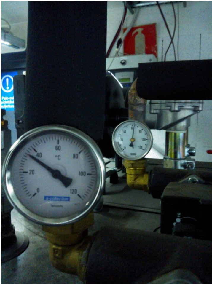
Kuva 14. Lämpötilamittareista seurataan veden lämpötila järjestelmässä. (Reinola 2015)
