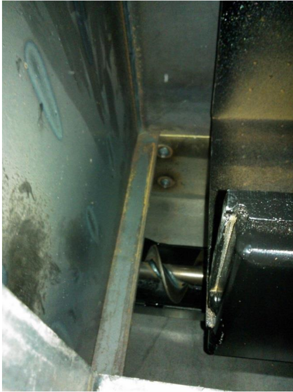
Kuva 23. Palopesän pohjalla on tuhkaruuvi, joka kuljettaa tuhkan pois kattilasta (Reinola 2015)
