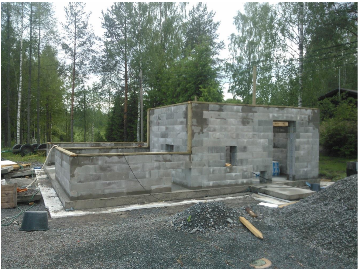
Kuva 5. Valuharkosta on tehty kattilahuone ja vasemmalla hakesiilon pohja. (Reinola 2014)
