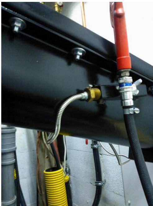
Kuva 1. Painevesi sprinkleri syöttöruuvissa ennen hakesiiloa (Reinola 2015)
