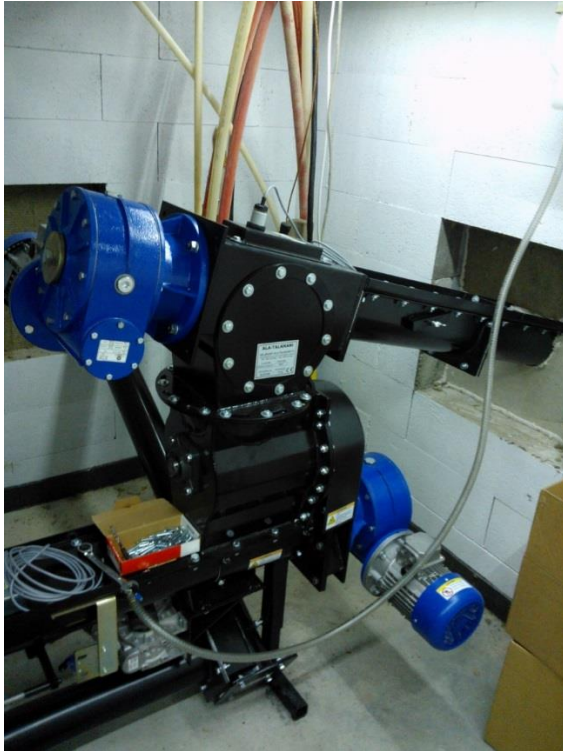
Kuva 20. Hake kulkeutuu kattilahuoneeseen ruuvikuljettimella, kuvassa myös sulkusyötin (Reinola 2015)
