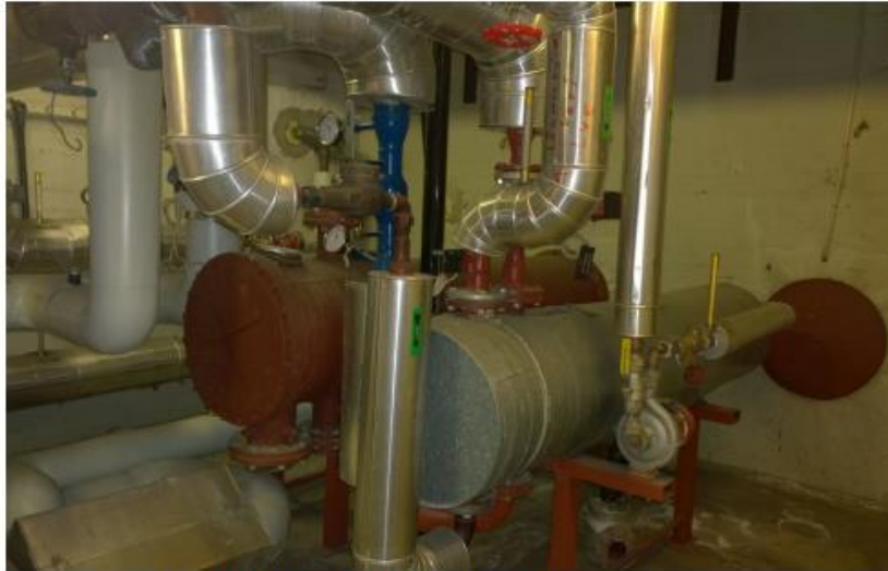
Kuva 5. Uusi ja vanha lämmönsiirin. taustalla kolmas siirrin.
