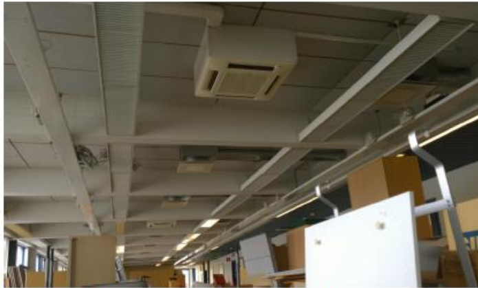
Kuva 5. Toimistossa olevien split-jäähdytys-yksikköjen kompressorilauhdutin on vesikatolla.
