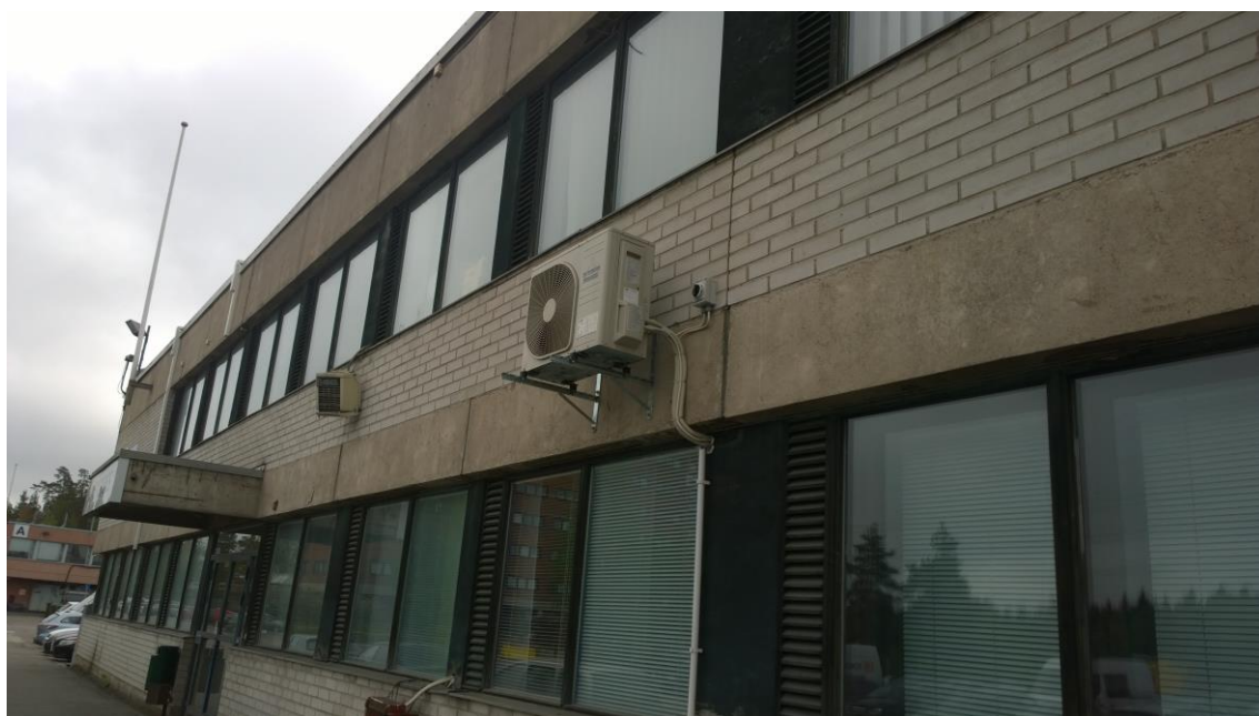
Kuva 14. B-rakennuksen seinustalla olevia puhallinkonvektoreiden ulkoyksiköitä.
