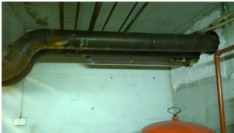
Kuva 6. Lämmönjakohuoneen asbestipitoisista putkieristeistä osa on otettu pois, mutta rakenteiden sisällä saattaa vielä olla vanhoja eristeitä.
