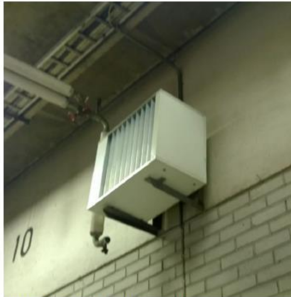
Kuva 8. Hallissa olevia kierrätysilmalämmitimiä.
