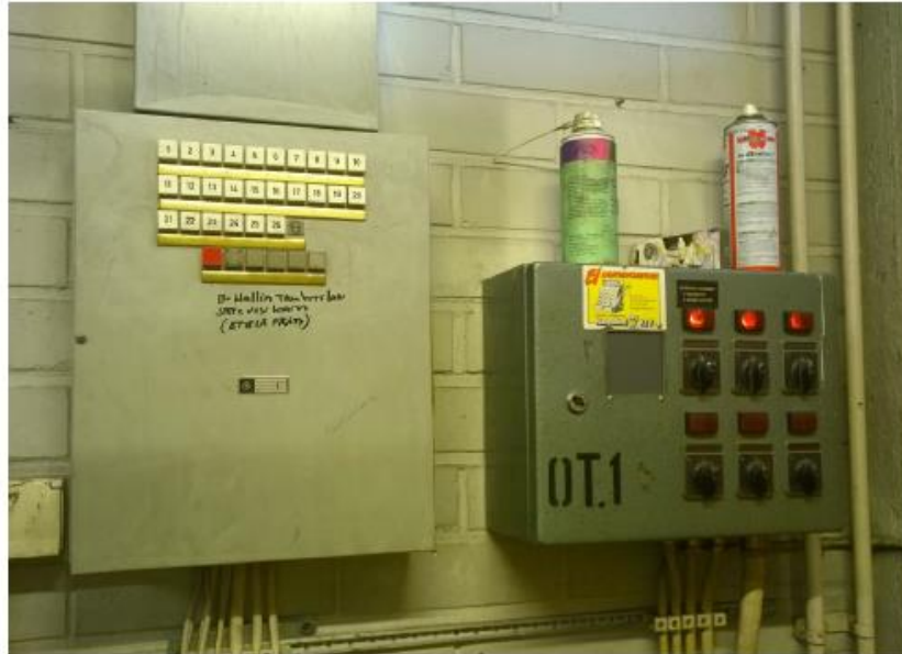
Kuva 3. Lämmönjakohuoneessa oleva VAK.
