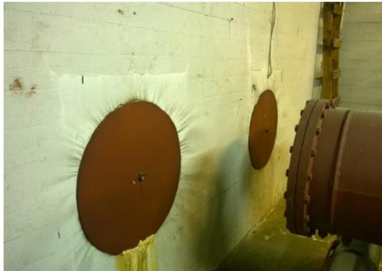
Kuva 4. Savupiipuille menevät aukot ovat tukittu.
