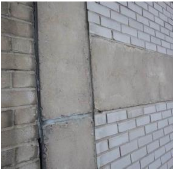
Kuva 4. Lyijy-yhdisteitä sisältävää saumamassaa [6].
