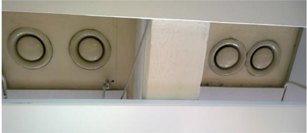
Kuva 6. Toimiston 2. kerroksen poistoilmaventtiilit ovat asennettu betonivaluun.
