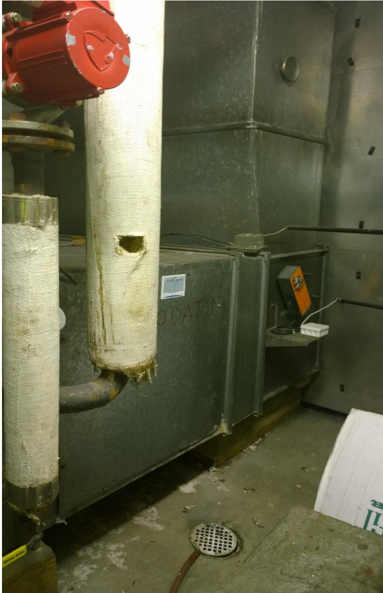
Kuva 2. Asbestipitoisella eristeellä eristettyjä ilmanvaihdon lämmitysputkia.
