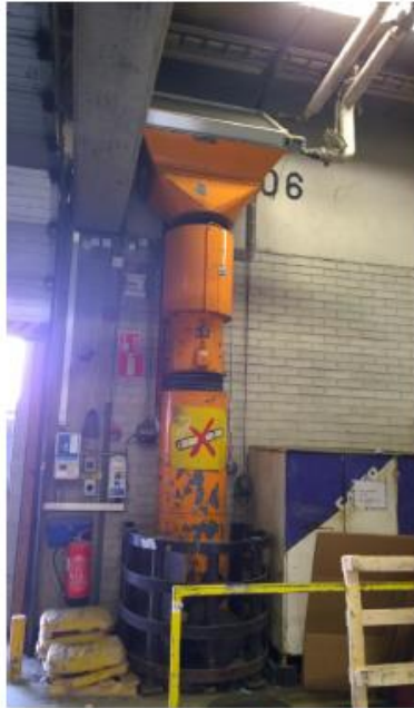
Kuva 9. Hallissa oleva oviverhokoje imee ilman katon rajasta ja puhaltaa sen lattian alle kanaaliin. Kanaalissa olevasta raosta ilma tulee oviaukkoon oviverhoksi. Kanaali puretaan tässä urakassa.
