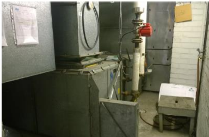
Kuva 6. Toimisto-osassa on erillinen tuloilmakone. Poistoilma imetään vesikaton huippuimureilla.
