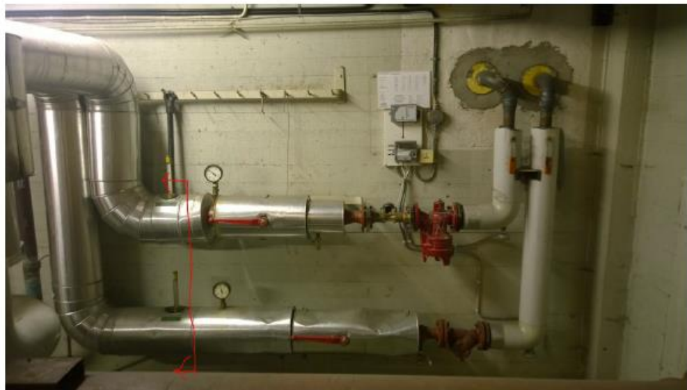
Kuva 4. Lämmönjakohuoneessa lämmitysputkien urakkaraja mittauskeskuksen jälkeen.
