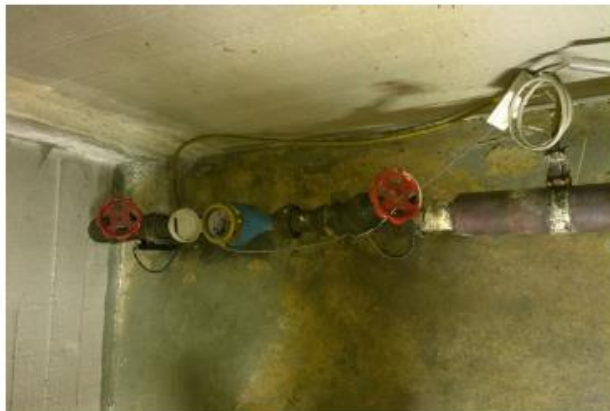
Kuva 2. Lämmönjakohuoneessa sijaitseva vesimittari on sisäpurkuvaiheen urakkaraja.
