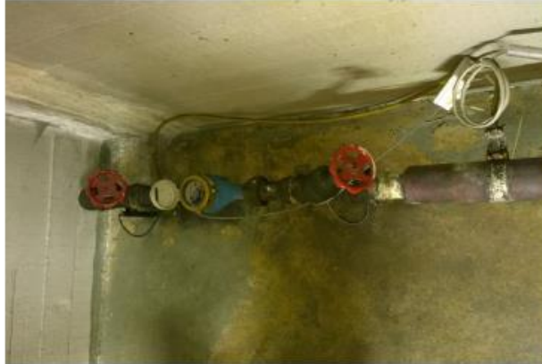
Kuva 1. Lämmönjakohuoneessa sijaitseva vesimittari on sisäpurkuvaiheen urakkaraja.
