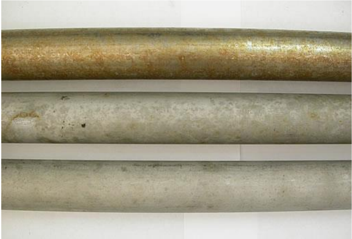
Kuva 7. Yleistä korroosiota rst-putkessa
