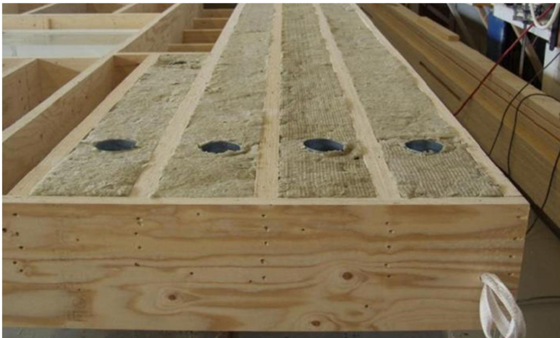
Kuva 11. Ilmanvaihtokanavia TES-elementissä [72, s. 19].
