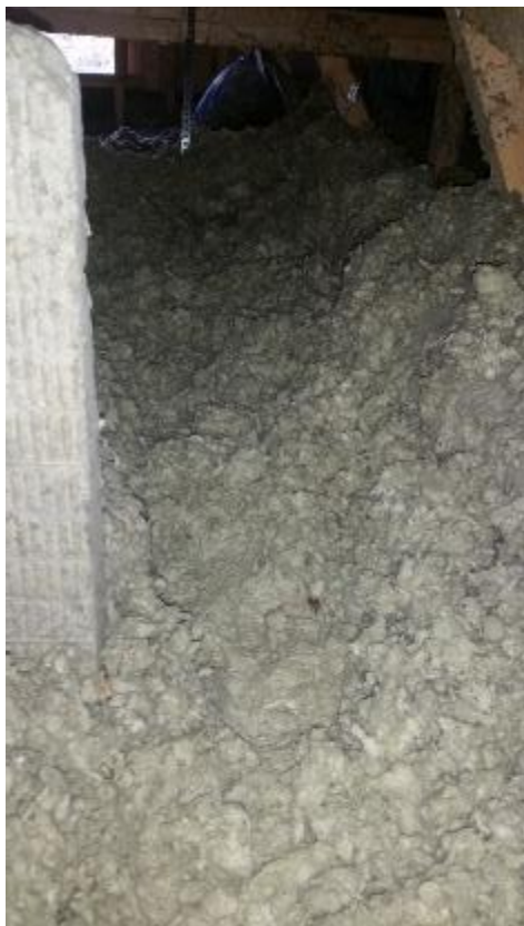
Kuvio 18. Puhallusvilla on painunut koko rakennuksen pituudelta.
