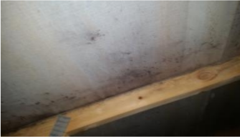
Kuvio 16. Aluskatteessa on mikrobivaurio.
