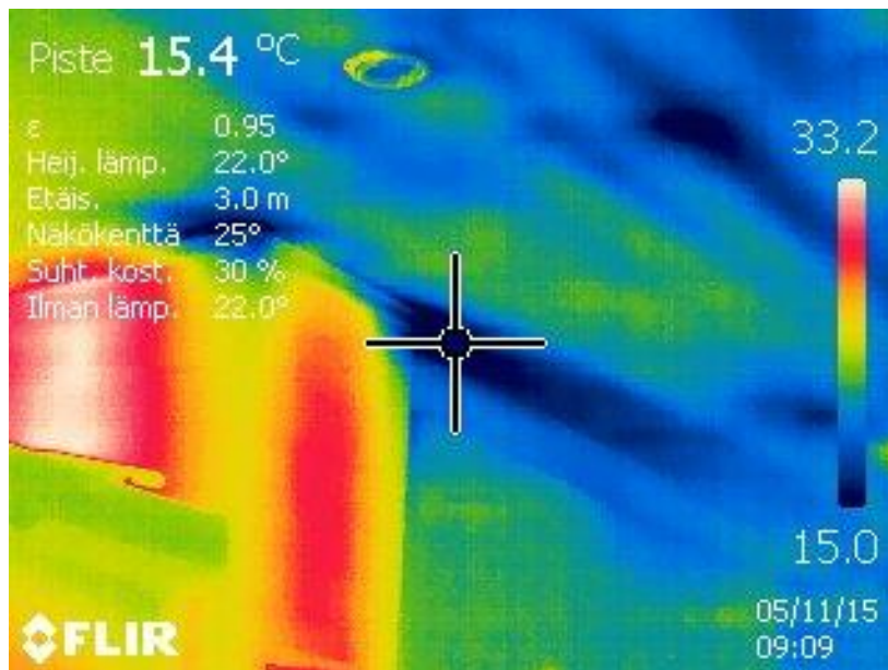
Kuvio 11. Keittiön katto. TI 75 %, korjausluokka 4.
