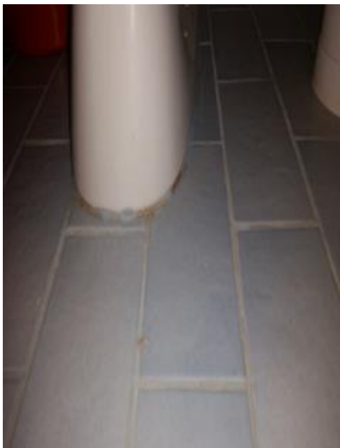
Kuvio 57. Wc -istuimen silikonitiivistys pesuhuoneessa.
