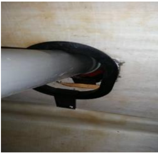
Kuvio 47. Kuvan läpivienti ei ole tiiviisti aluskatteessa.
