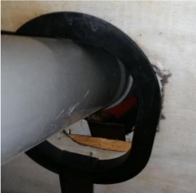
Kuvio 17. Läpivienti ei ole tiivis.
