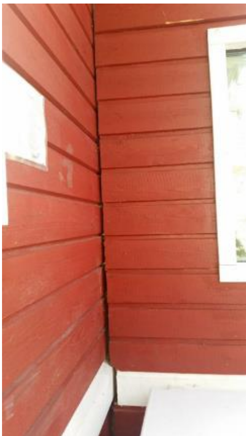
Kuvio 36. Terassin ja ulkoseinän liitos on irti toisistaan.
