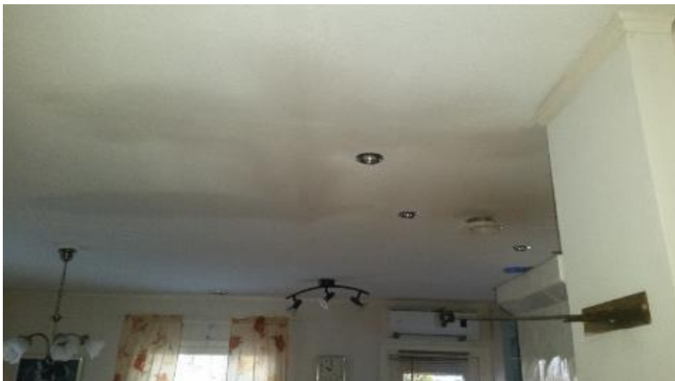
Kuvio 52. Olohuoneen katossa jälkiä pintakorjauksista.
