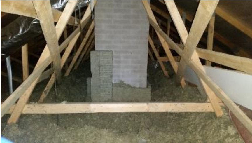
Kuvio 14. Yläpohjassa ei ole kulkusiltoja ja eriste on painunut.
