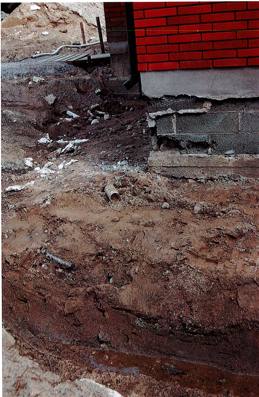
Kuva 24. Talon nurkalla rakennusaikana asennettu, tukkeutunut salaoja.
