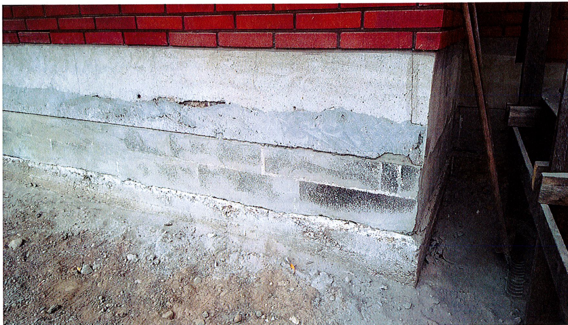
Kuva 34. Sokkelin ns. tasoiteryhmän jäljiltä korjattua jälkeä.
