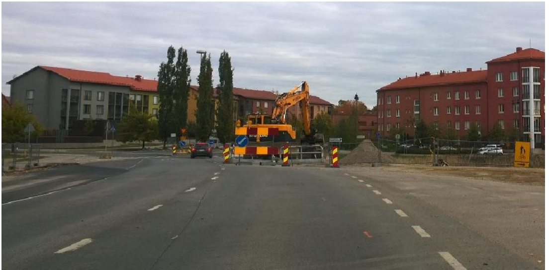
Kuva 5. Tilapäisissä liikennejärjestelyissä Ylästöntiellä on käytetty S2-luokan sulkulaitteita sekä sulkupyväitä. Sulkulaitteiden värit ovat keltainen ja punainen.
