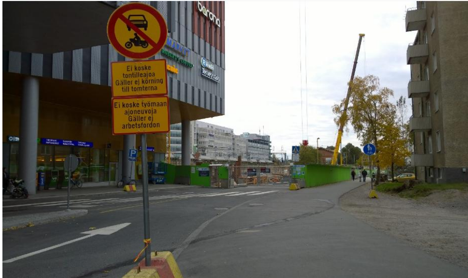
Kuva 4. Dixi II:n työmaa sijaitsee Tikkurilan juna-aseman välittömässä läheisyydessä. (Marika Sirkiä, Vantaan kaupunki)
