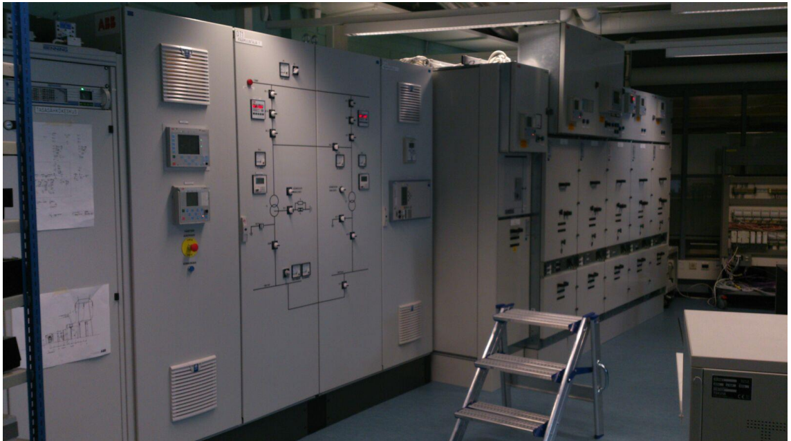
Kuva 5. 110 kV / 10 kV oppimisympäristö.
