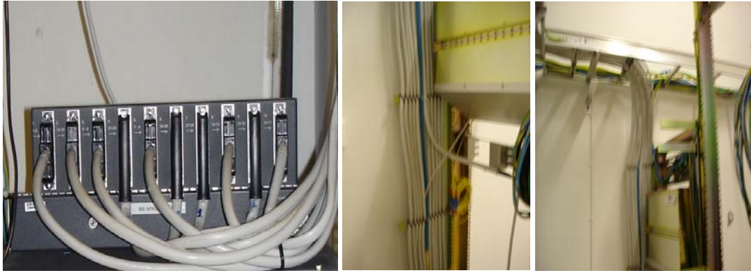
Kuva 17: Tilaaja kaapelit on kytketty keskittimeen ja kaapelit vedetty siististi kohti kytkentä rimoja.
