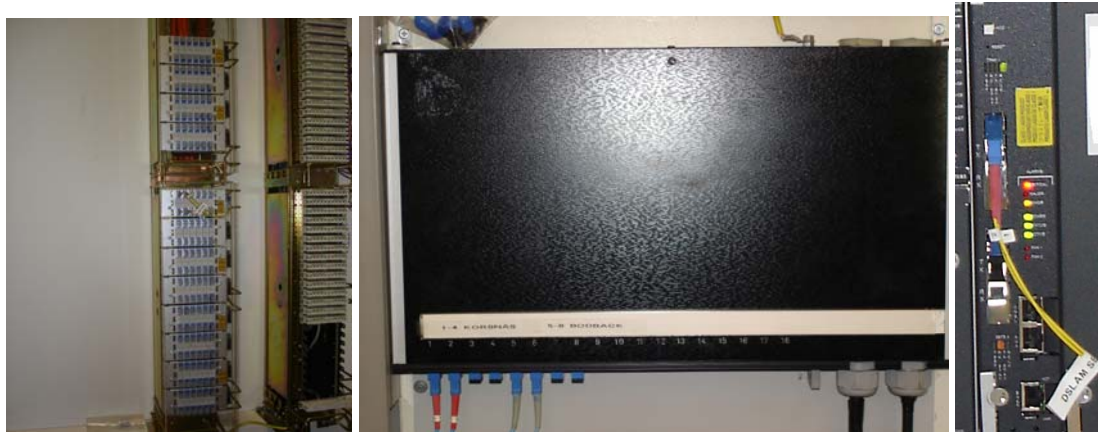
Kuva 16: Kytkentäpaneeleja on erikokoisia. Kuvassa on esitetty kaksi erilaista. Oikean puoleisessa kuvassa kytkentäkuitu on liitetty keskittimeen.
