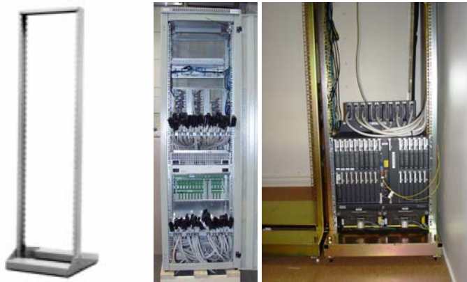
Kuva 7: Esimerkkejä laitetelineistä ja kaapeista. /15/
