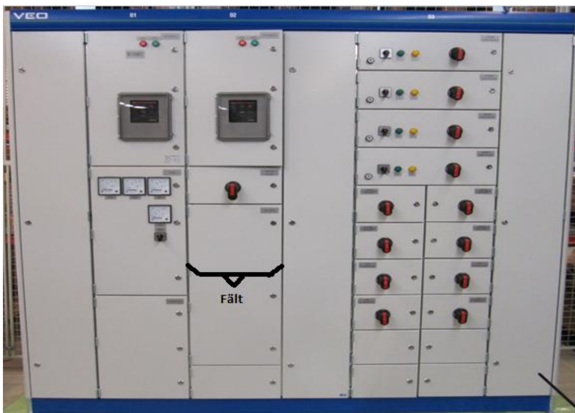
Figur 10. Del av ett lågspänningsställverk med 3 fält och tillhörande kabelutrymmen.
