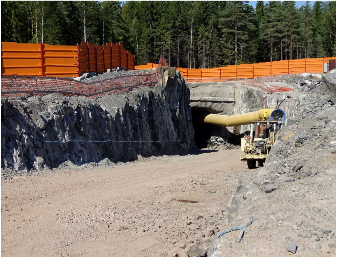
Kuva 2. Sammalvuoren metrovarikon ajotunneli. (3)
