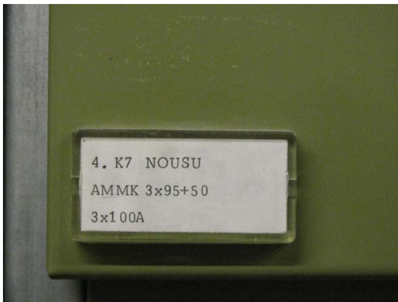
Kuva 9. Sähköpääkeskuksesta lähtevän nousun K7 :n sulake- ja johdinmerkinnät
