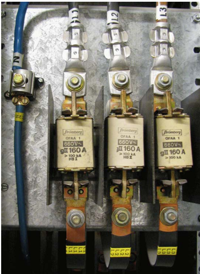
Kuva 10. Nousun K7 sulakkeet sähköpääkeskuksessa
