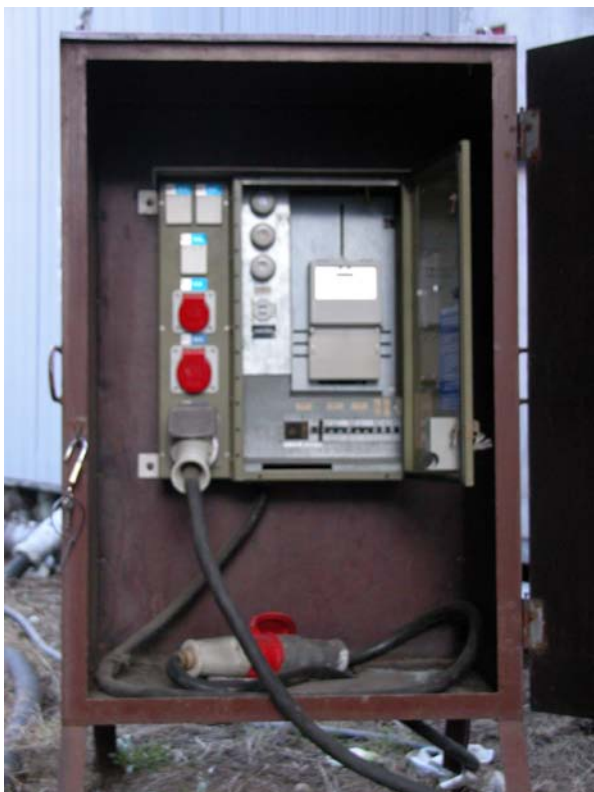
Kuva 16. Sähkölaitoksen kytkemä keskus
