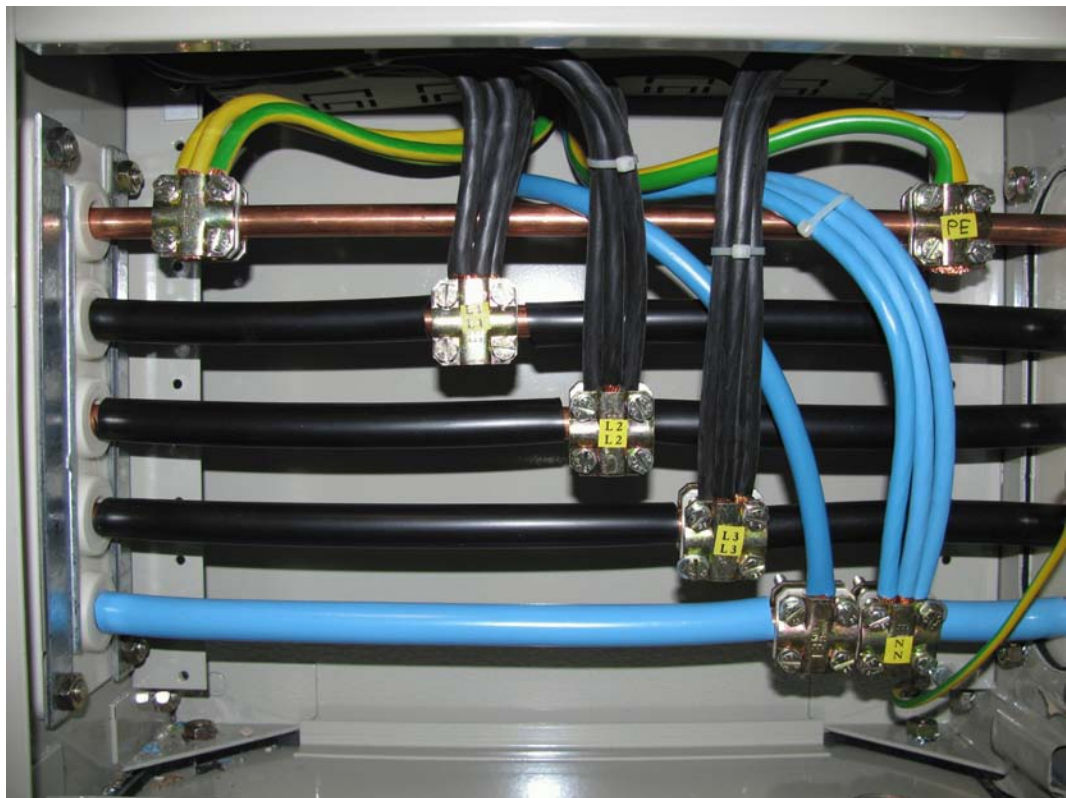
Kuva 6. Vanhan TTVO :n studion sähkökeskuksen jakokiskot
