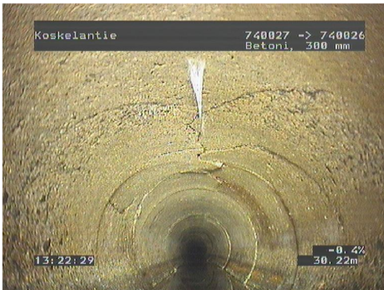
KUVA 5. Viemärikuvauksessa havaittu halkeama
