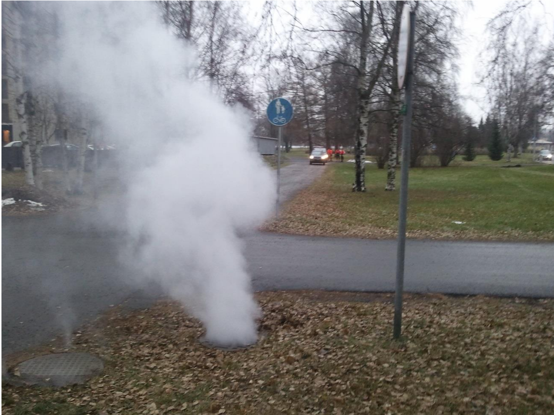
KUVA 12. Savukokeella todettu virheellinen hulevesikaivon liitos jätevesiviemäriin
