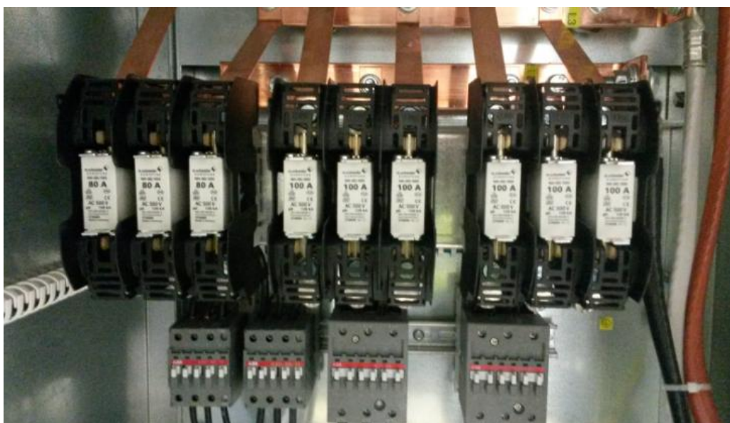
KUVA 13. Kompensointiyksikön MSB-03 varokesuojaus (Taskinen 2015-10-20.)
