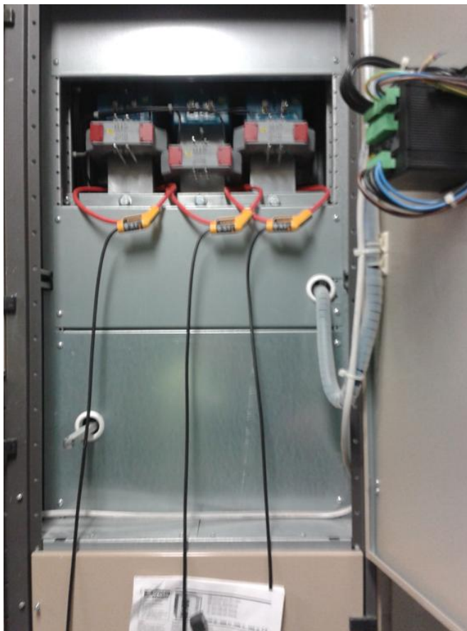
KUVA 5. Virtamittaus vaihekiskoilta keskuksella MSB-03 (Taskinen 2015-08-27.)
