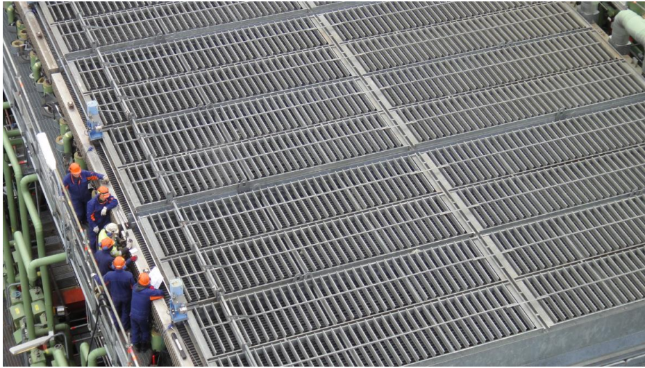
Kuva 5. Vuonna 2013 otetussa valokuvassa näkyy osa TL4:n ilmajäähdytetystä lämmönvaihtimesta, eli ilmajäähdyttimestä.
