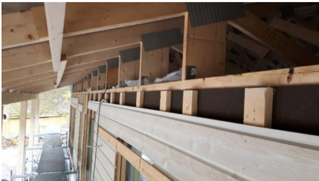
Kuva 14 Ulkovuoripaneelaus puuttuu ristikkojen kohdalta.
