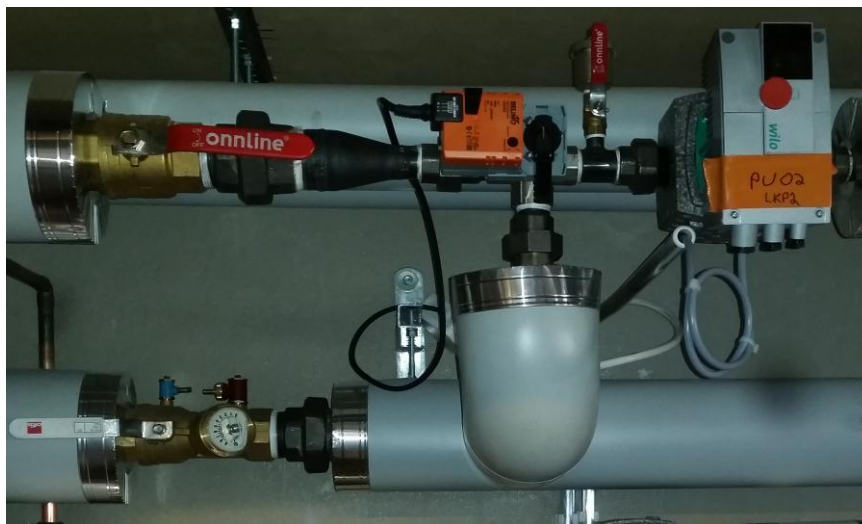
Kuva 13: Kuvan keskellä on 3-tieventtiili TV02 ja oikealla puolella on lattialämmitysverkoston pumppu PU02.
