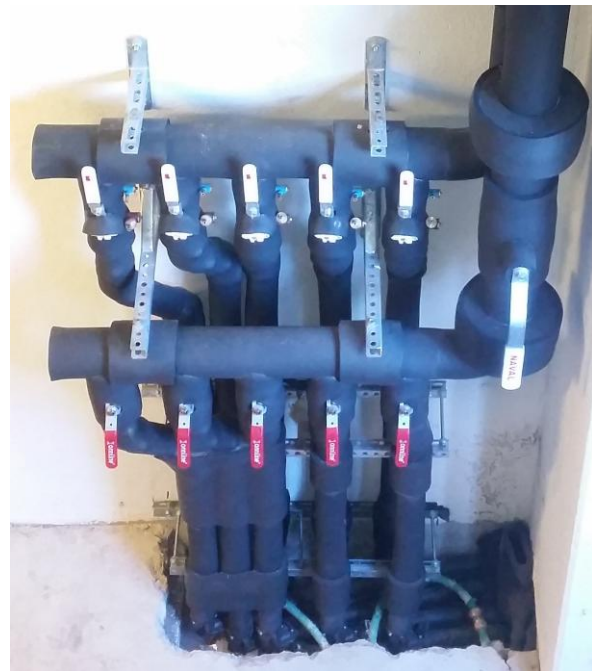
Kuva 16: Lämmönkeruuputkiston jakotukit, ylempi maalämpöpumpulle tuleva ja alempi maalämpöpumpulta lähtevä.
