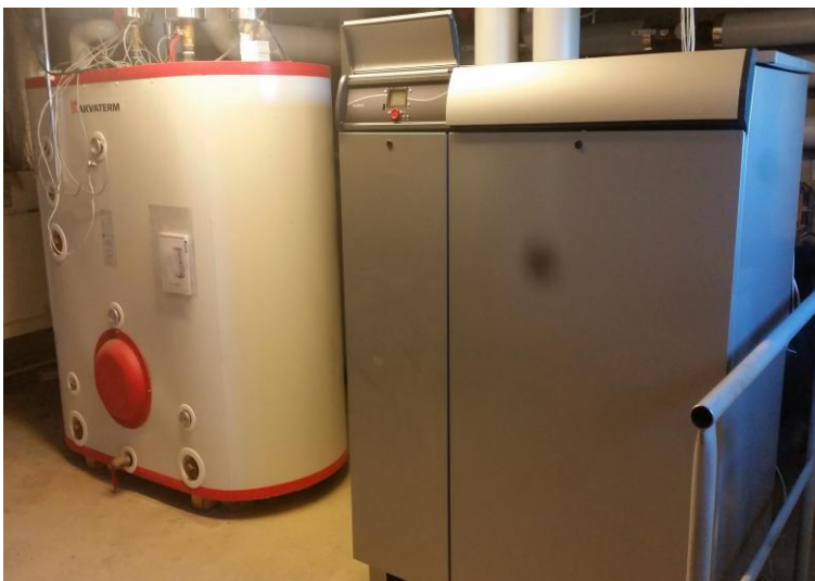
Kuva 9: Kuvan oikeassa reunassa Oilonin RE-70 maalämpöpumppu ja vasemmassa reunassa akvatermin 1400 l lämminvesivaraaja.
