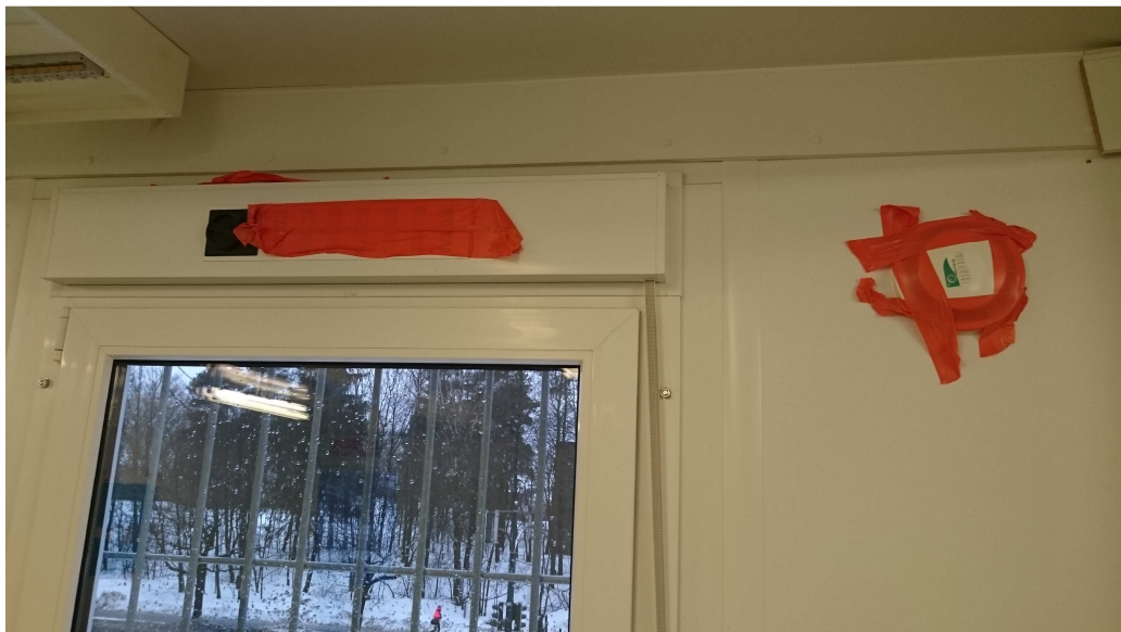
Kuva 3. Venttiilit ovat teipattuina
