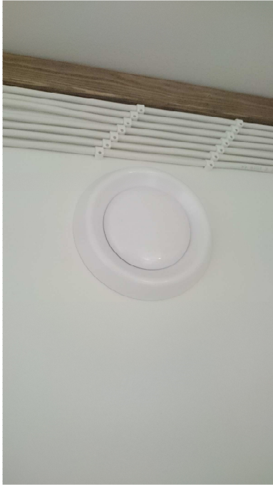
Kuva 3. Venttiilit ovat suljettuina
