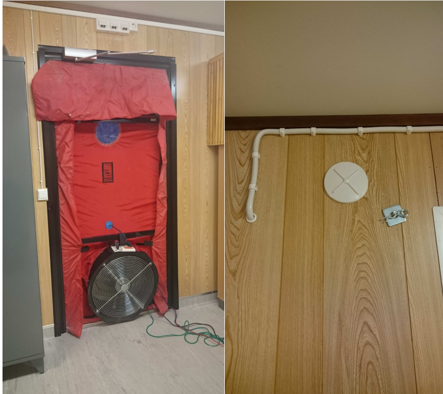
Kuva 2. Ovipuhallin on asennettuna ja korvausilmaventtiili suljettuna
