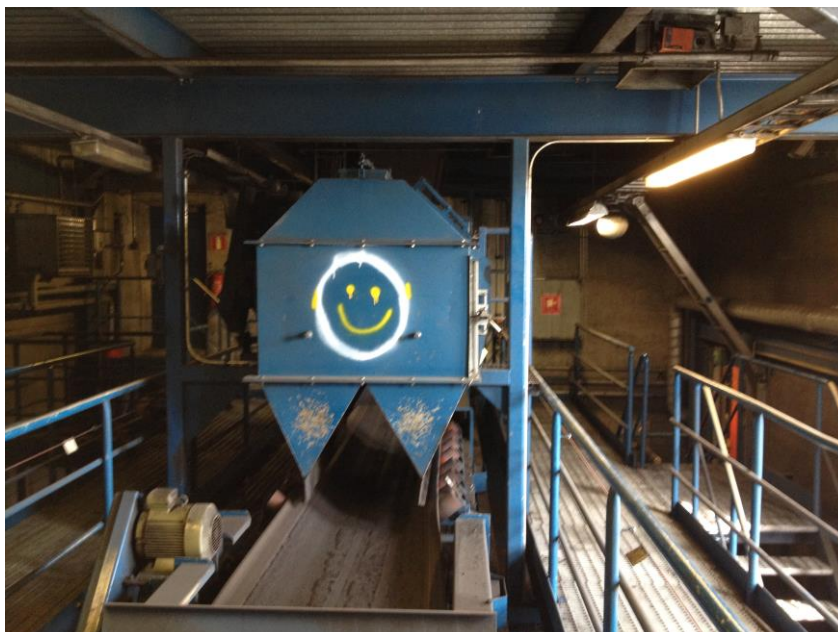
Kuva 14. Voimalaitoksen hiilisiilon valaistus
