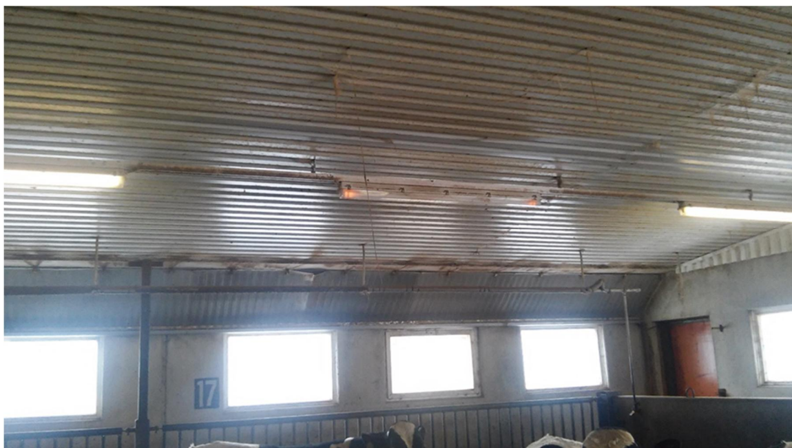
Kuva 10. Loisteputki hehkuu punaisena käyttöikänsä päättyessä (Lotvonen, 2015).
