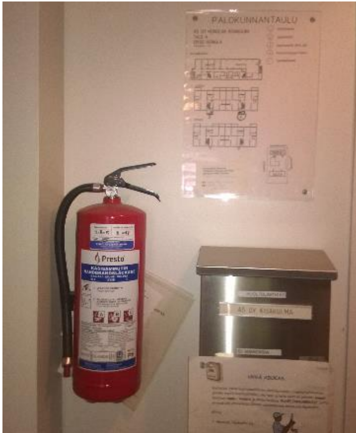
KUVA 24. Palokunnantaulu ja alkusammutuskalusto
