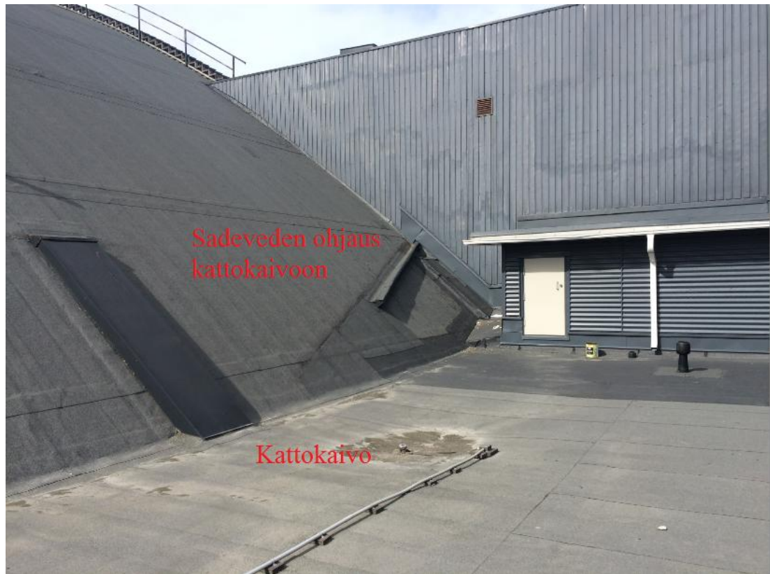
KUVA 12. Lapetta pitkin valuva sadevesi ohjattu kohti kattokaivoja.
