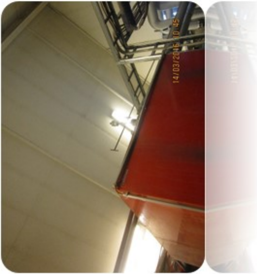
Kuva 1: työasolta puuttuvat kaiteet ja potkuraudat
