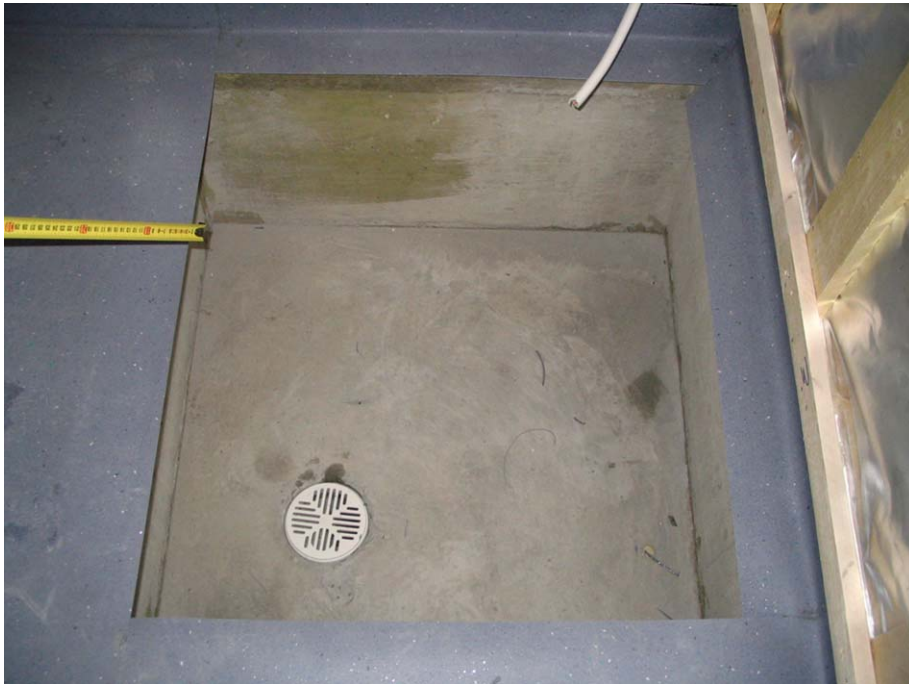
Kuva 29. Kiukaan upotustila lattiataason alapuolelle (Kuhmon palvelutalo Kultakuusi)
