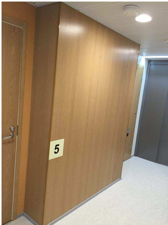
Kuva 13. Palokotelo rappukäytävässä. [Kuvannut: Mikko Kamppuri]
