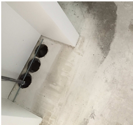
Kuva 18. Suunnitteluvirhe sähköläpimenoille. [Kuvannut: Mikko Kamppuri]
