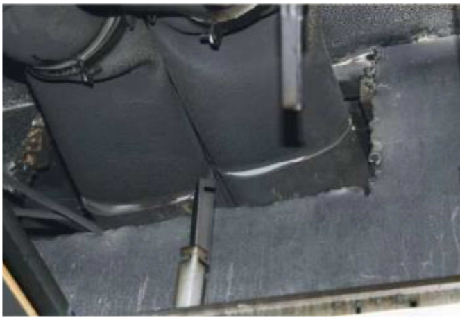
Kuva 16. Palon leviäminen läpiviennin kautta alakaton yläpuolella. [16.]
