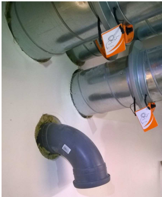
Kuva 11. Seinän läpivientiputket ilman palokatkoja. [Kuvannut: Mikko Kamppuri]
