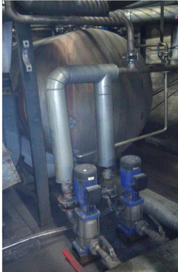
Kuva 11. Voimalaitoksen lauhdesäiliö ja lauhdepumput
