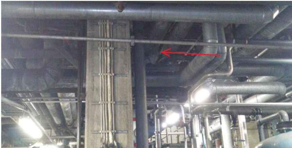
Kuva 12. Mildola Oy:n hajukaasunlämmönvaihtimen poistolinja
