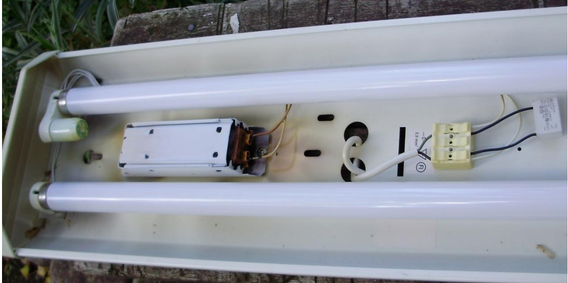
KUVA 45. Nollavian vaurioittama loistevalaisin
