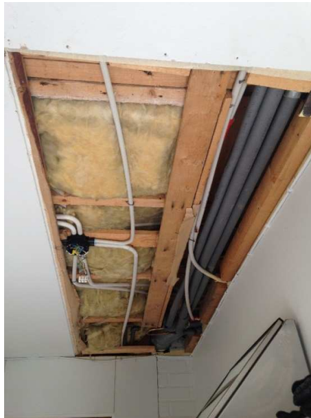
Bild 19. Takskiva som saknas utanför matsalen, p.g.a tidigare läckage.
