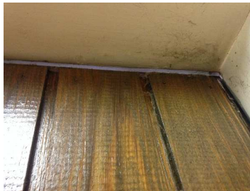
Bild 27. Väldigt gles dörr i det allmänna tvättutrymmet mot insidan.
