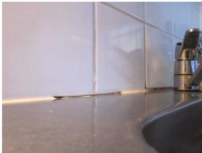
Bild 11. Dålig silikonmassa mot kakelplattor.
