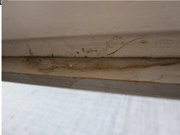
Bild 12. Fukt som kommit från fönstret i lägenhet 13 (gårdskar).
