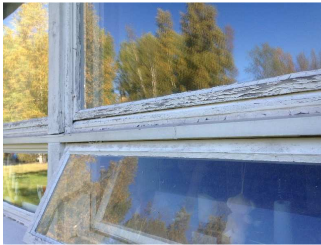
Bild 7. Här kan man se att fönstren behöver förnyas samt förbättras.
