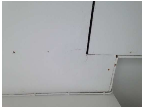
Bild 19.1 Också läckage bredvid bild 19.
