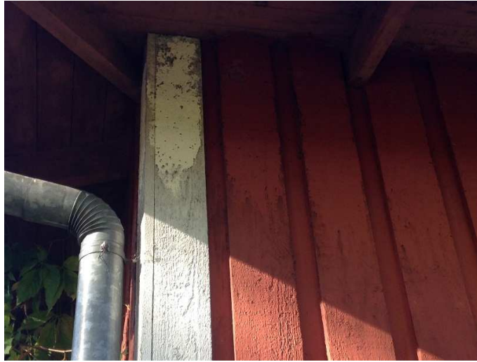
Bild 6. Missfärgningar på täckbräde.
