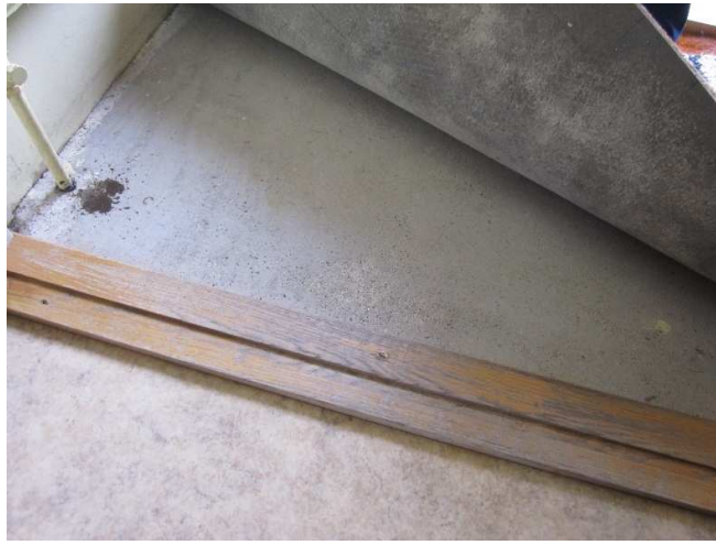
Bild 15. Alla lägenheter saknar ytmaterial i vindfånget.
