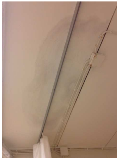
Bild 26. Troligt fuktproblem i det allmänna tvättutrymmet.
