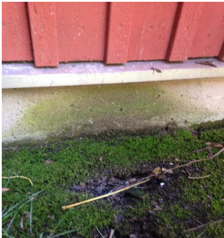
Bild 2.1 Mycket våt sockel med mossväxt intill, marken samt sockeln hålls konstant våt.
