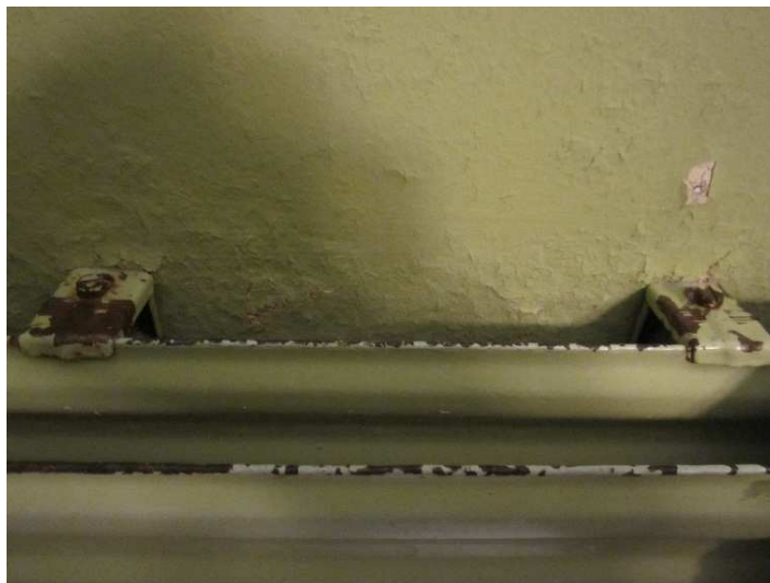
Bild 13. Lägenhet 8 ser ut att ha fuktproblem i vindfånget.
