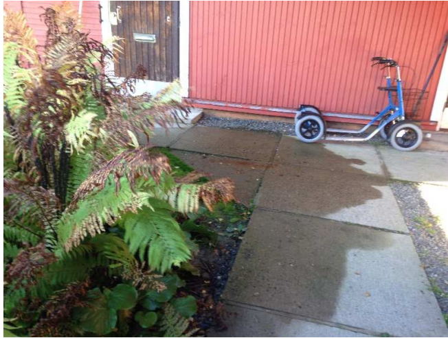
Bild 9. Denna bild visar att stuprören är dåliga.
