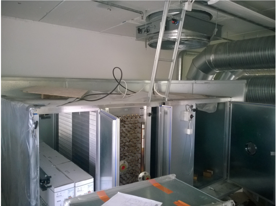
Kuva 18. IV-kone asennettuna, loppuosien mitoitus varten
