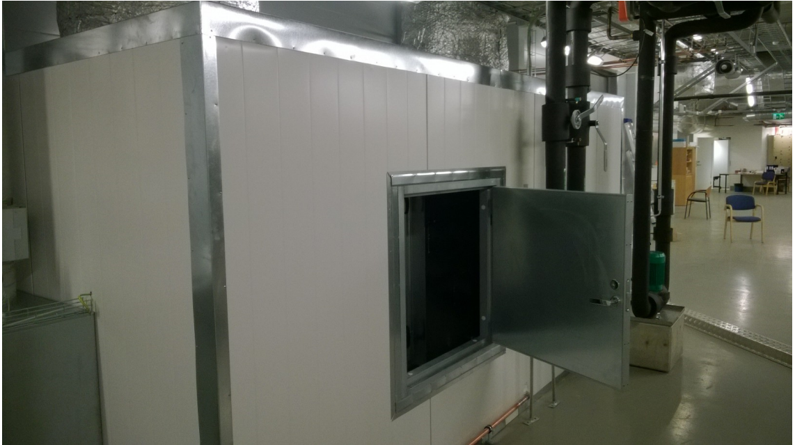
Kuva 9. Sandwichelementeillä koteloitu ammattikeittiön IV-kone
