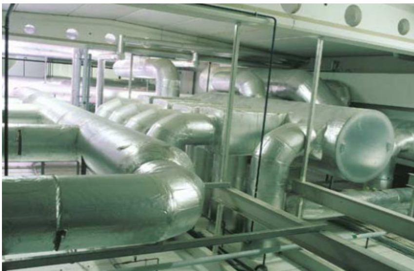
Kuva 1. Kondenssieristettyjä IV-kanavistoja [5, s. 24]
