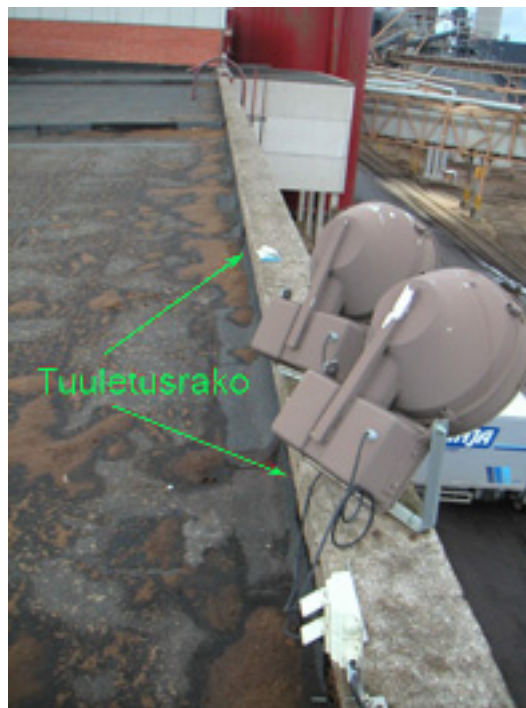
Kuva 28. Pakkalinjan pellittämätöntä räystästä
