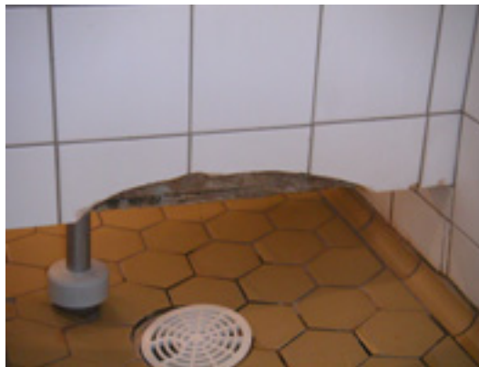
Kuva 13. Suihkunurkkauksen väliseinän vaurioitunut alaosa
