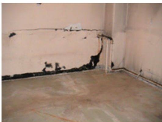
Kuva 21. Epäonnistunut vedenpaineen eristys keskusvaraston kellarissa
