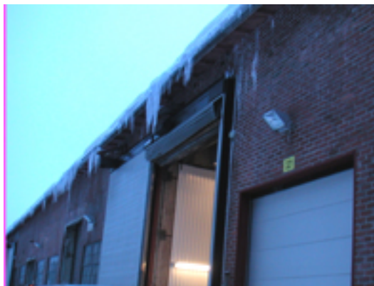
Kuva 9. Autokorjaamon räystäään ”jääpuraita” helmikuussa 2004
