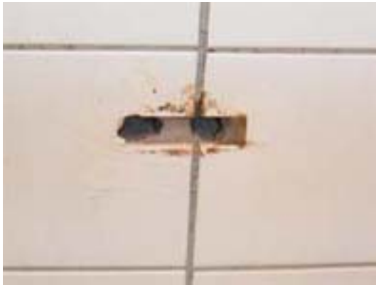
Kuva 11. Poistettujen putkien reiät ovat jääneet tukkimatta suihkun seinästä.
