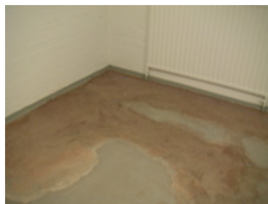
Kuva 22. SC-hiomon väestönsuojan veden sotkema lattiaa
