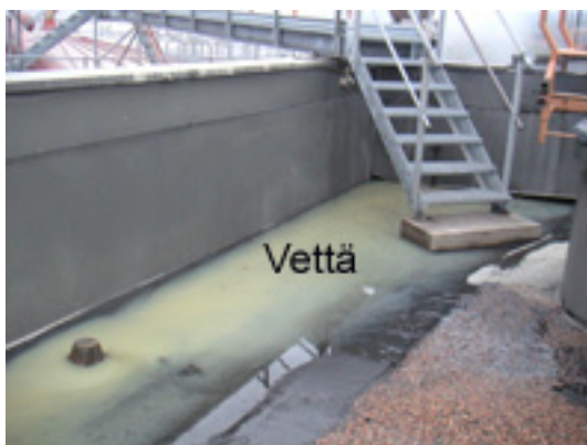
Kuva 7. TMP:n tukkeutunut katto-kaivo
