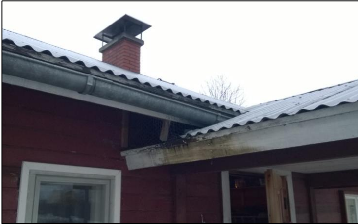
KUVA 2.5 Vaurioitunut vanhan kuistin kattorakenne (Kuva: Antti Naukkarinen 2016)
