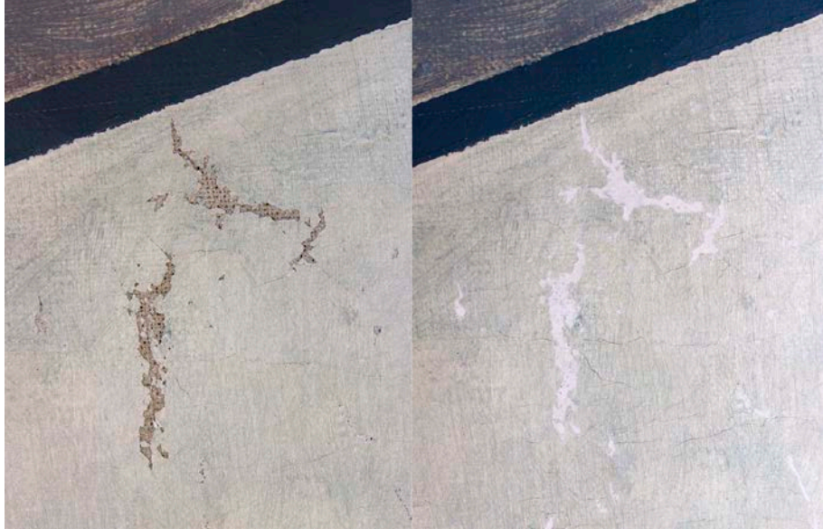
KUVA 26. Puutosalue ennen ja jälkeen kittauksen.
