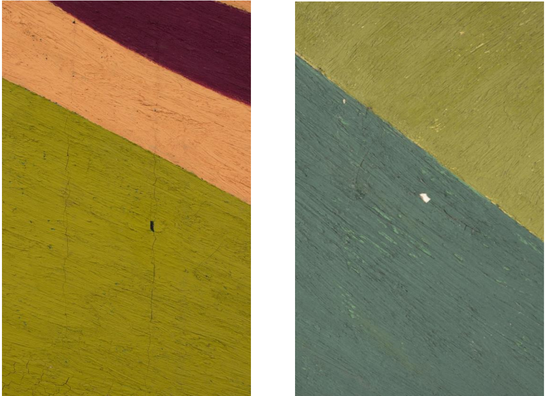
Kuvio 23. Kiilakehyksen poikkirima on aiheuttanut maalipinnan halkeiluja sekä pieniä puutoskohtia.
