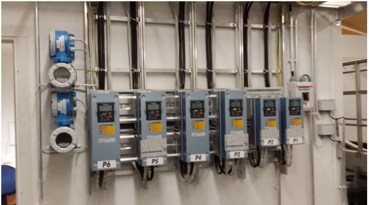
KUVA 1. Vacon-taajuusmuuttajia Vesikolmio Oy:n käytössä.
