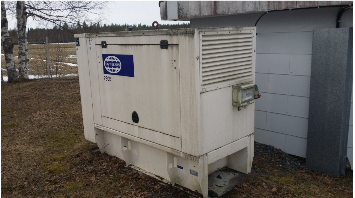
KUVA 2. Vesikolmio Oy:n käytössä oleva dieselkäyttöinen varavoimakone
