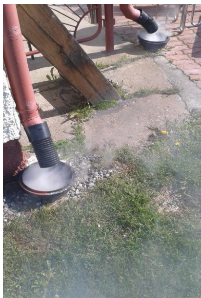
Kuva 6. Syöksytorvien alta, rännikaivoista purkautuu savua.
