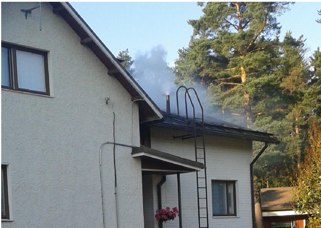
Kuva 12. Savu purkautuu kiinteistön viemärin tuuletusputkesta.
