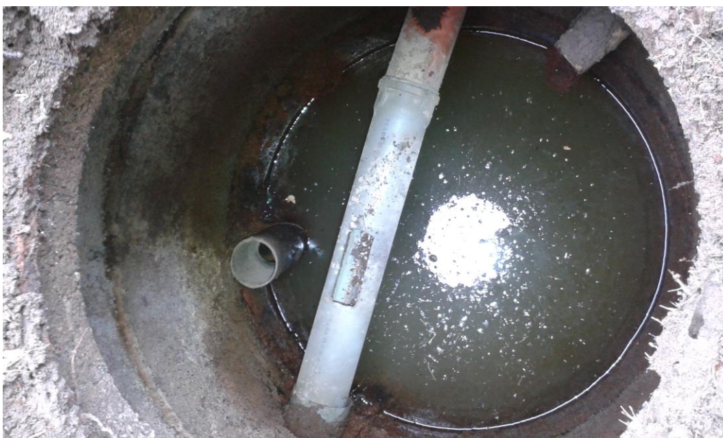
Kuva 14. Sadevesikaivo, jonka läpi kulkee jätevesiviemäri.
