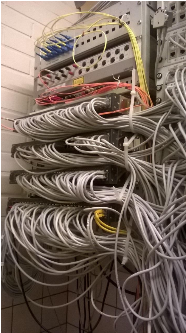
Kuvio 2. Oppi3-rakennuksen yläkerran kytkimiä
