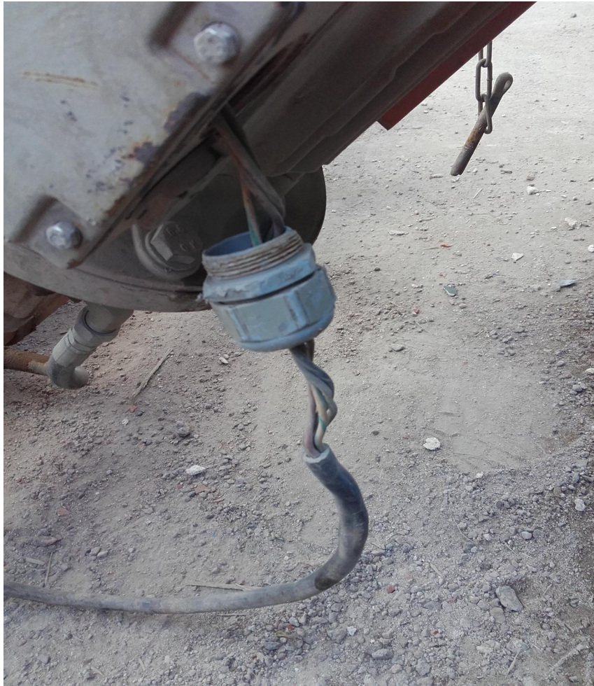
Kuva 1. Hihnakuultimen kaapelin sisäiset johtimet näkyvät ja vedonpoisto puuttuu.(Juha OI-jakka)
