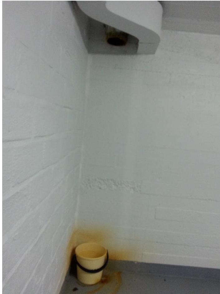
KUVA 16. Vanha viemäriputki vuotaa vettä varastuhuoneeseen
