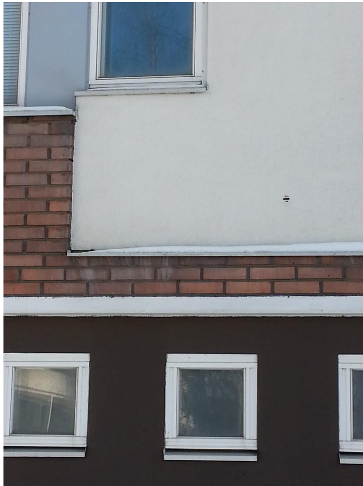
KUVA 6. Kosteuden aiheuttamia jälkiä tiiliverhouksessa
