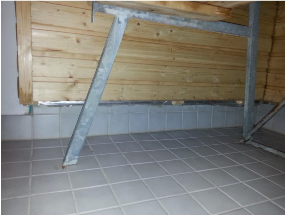
KUVA 15. Saunan seinän alumiinipaperi puutteellisesti kiinnitetty rakenteeseen
