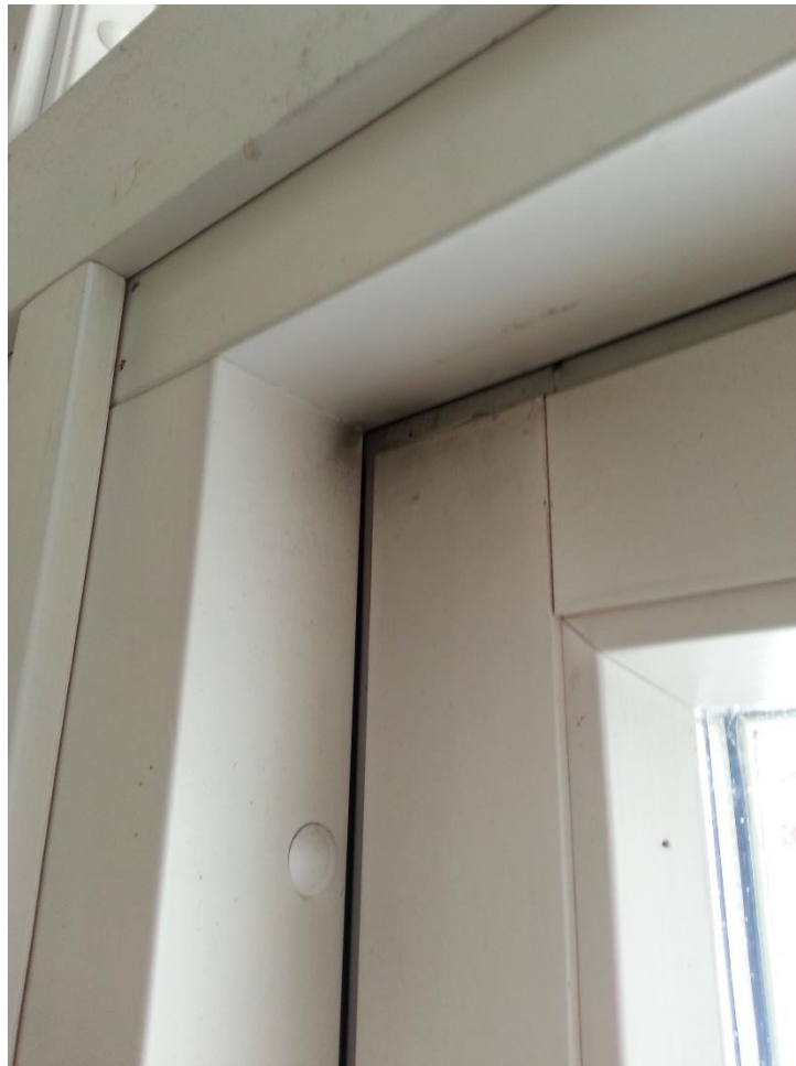
KUVA 23. Parvekeovien tiivisteet vuotavat
