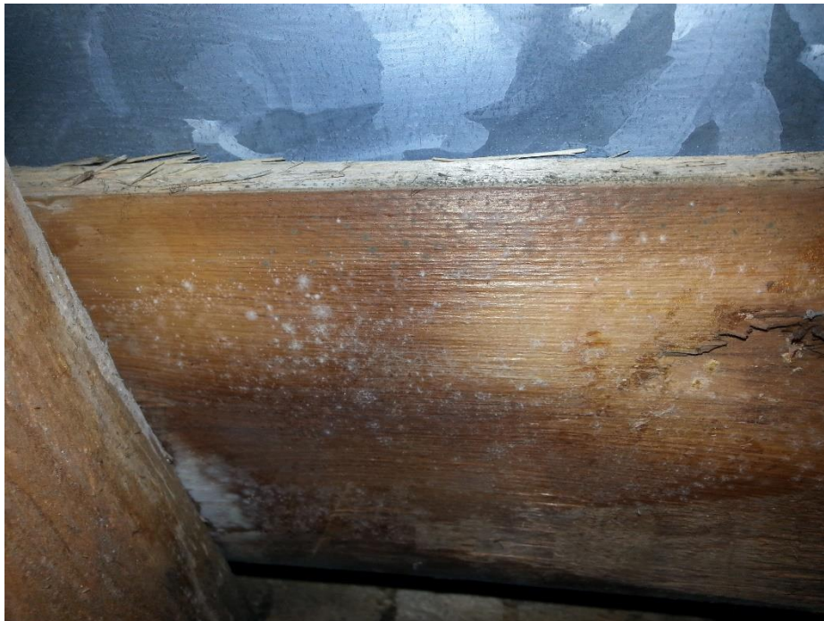
KUVA 27. Vesikaton homehtunut aluslaudoitus
