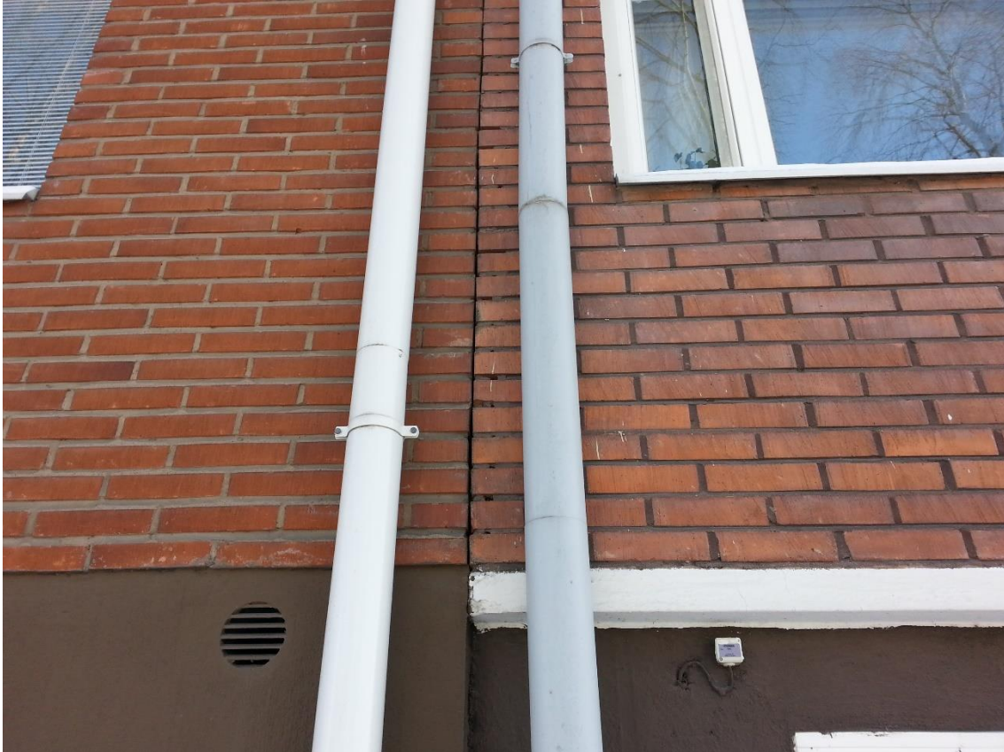
KUVA 5. Julkisivu lounaaseen, tiilverhouksen saumoissa vaurioita ja puuttuvat tuuletusraot
