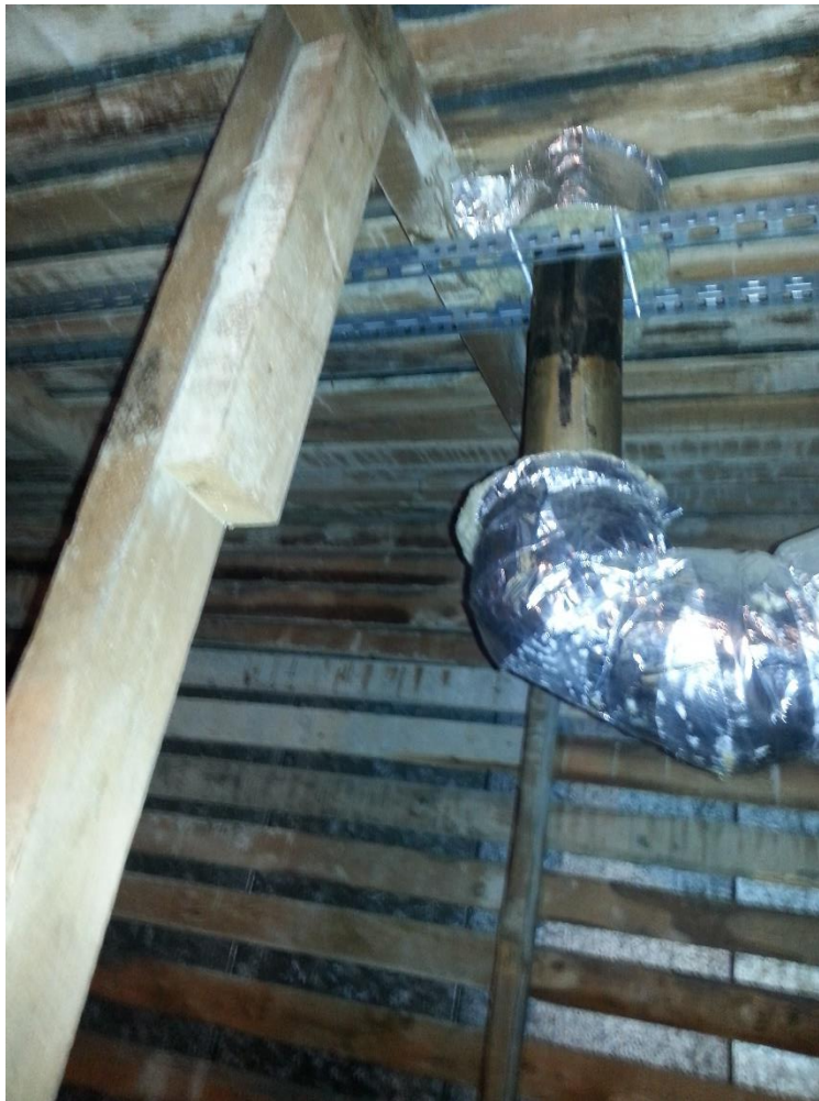
KUVA 28. Osittain eristämätön viemärintuuletusputki
