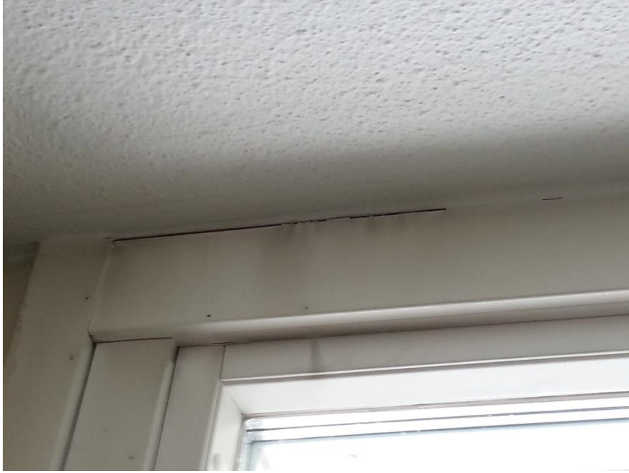
KUVA 24. Parvekeoven yläpuolella katon rajassa ilmavuoto
