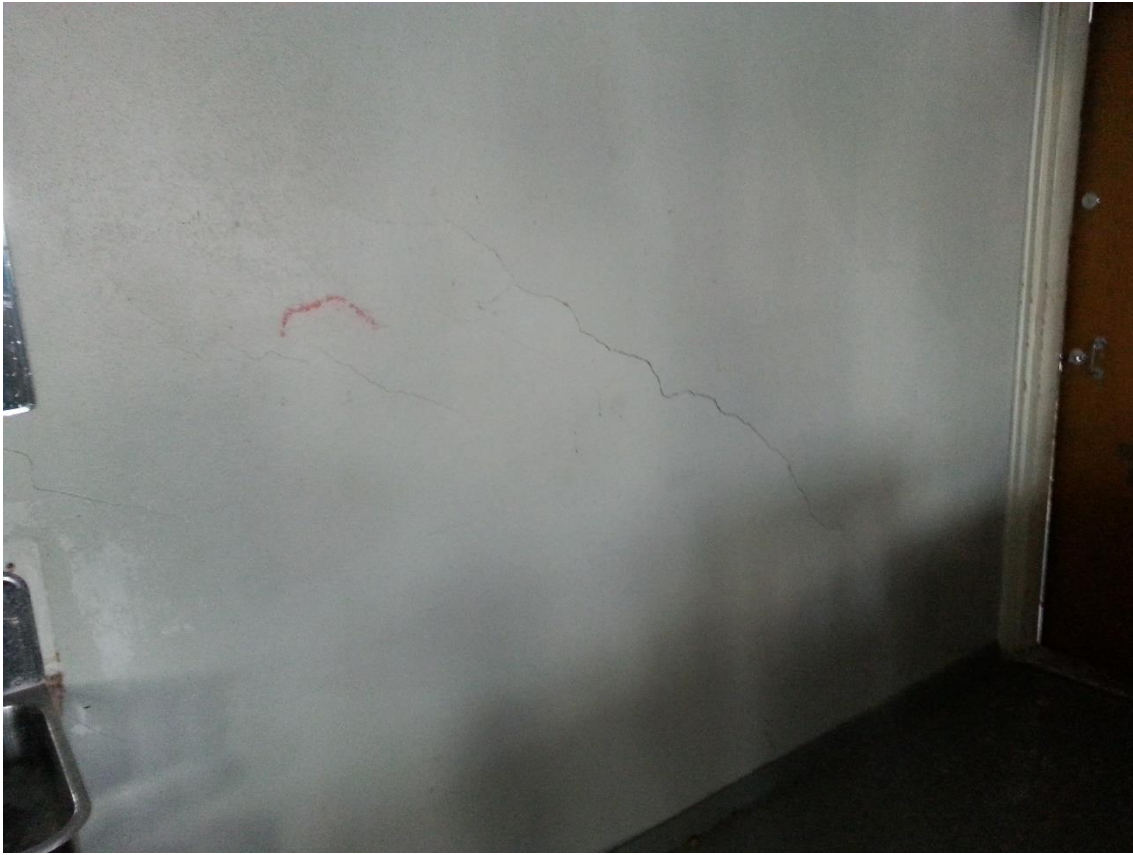
KUVA 9. Varastohuoneen seinän halkeamat ja kulunut maalipinta
