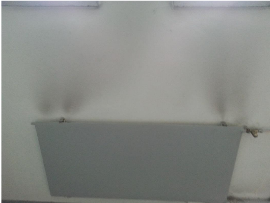
KUVA 10. Likaisen ilman aiheuttamat tummumat seinissä
