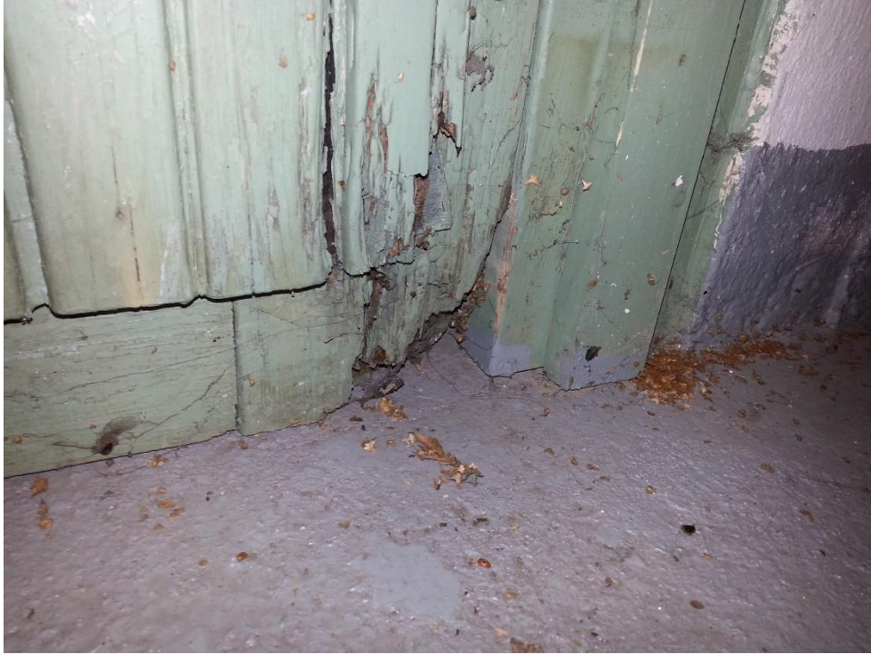
KUVA 19. Väestönsuojan oven edessä oleva lahonnut väliovi
