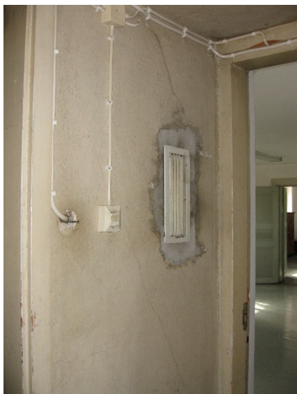
Kuva 7. Tuloilmaelin 4. kerroksessa (Liimatainen 2015).
