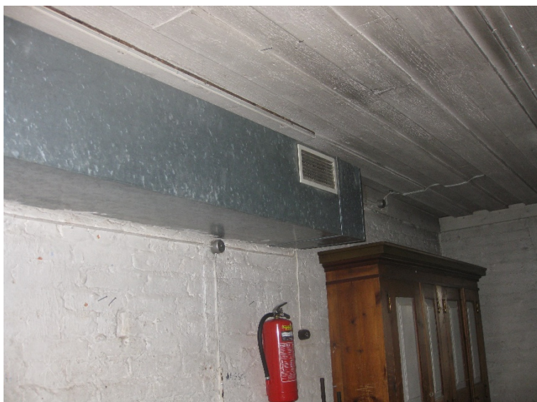
Kuva 8. Tuloilmaelin ja levityskanava salin eteisessä (Liimatainen 2015).
