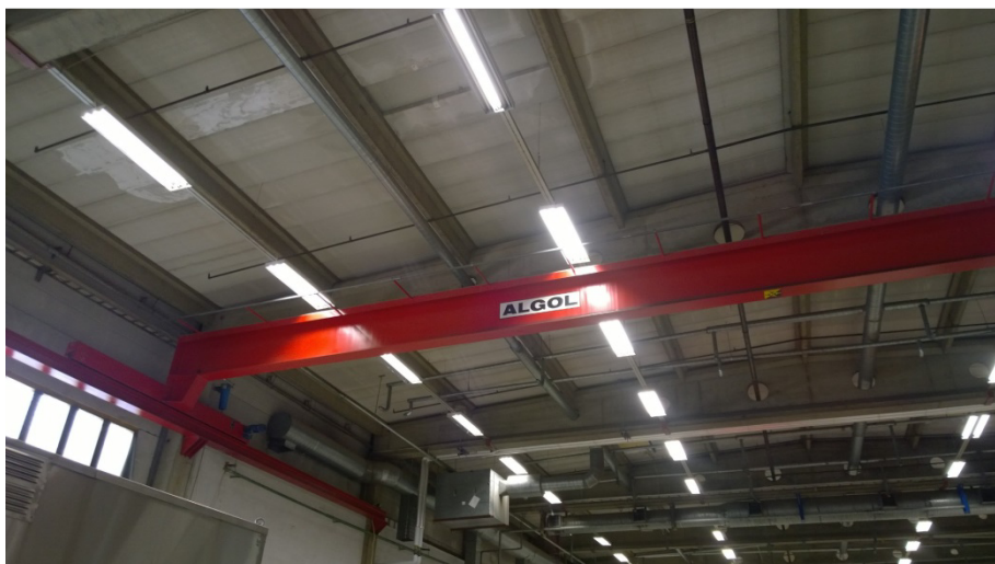
KUVA 4. Teollisuushallin valaistusta 3x58W loisteputkivalaisimilla Siikarannan kiinteistössä (Puputti 2016-04-08).
