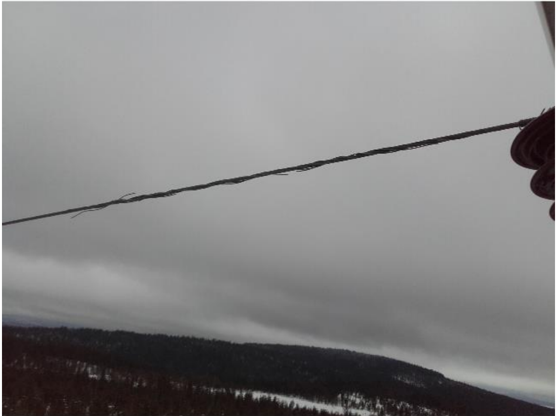
Kuva 2. Tarkastuksissa tulee kiinnittää huomiota johtojen kuntoon.
