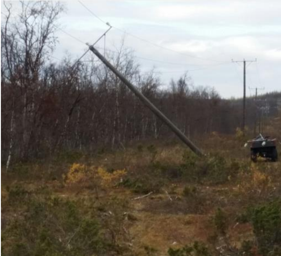
Kuva 6. Tyvestä lahonnut pylväs on kaatunut ja on sen vuoksi aiheuttanut toimintahäiriötä sähköverkkoon.
