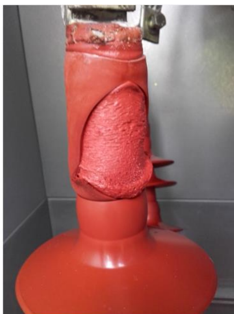
Kuva 9. 20 kV kaapelipäätteen pintavirrankestävä letku revennyt.
