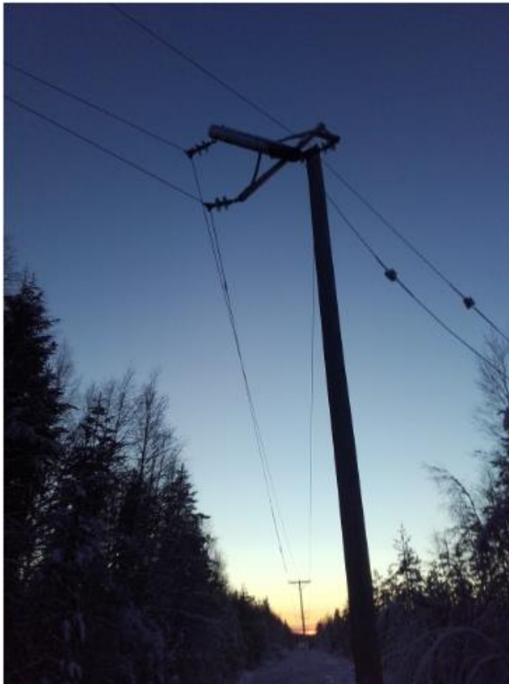
Kuva 7. 20 kV kulmapylväs poikki. Harusvaijeri on heikentänyt pylvään kuntoa.
