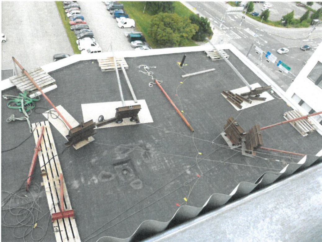
Kuva 4. Työkelkkojen vastapainot katolla.
