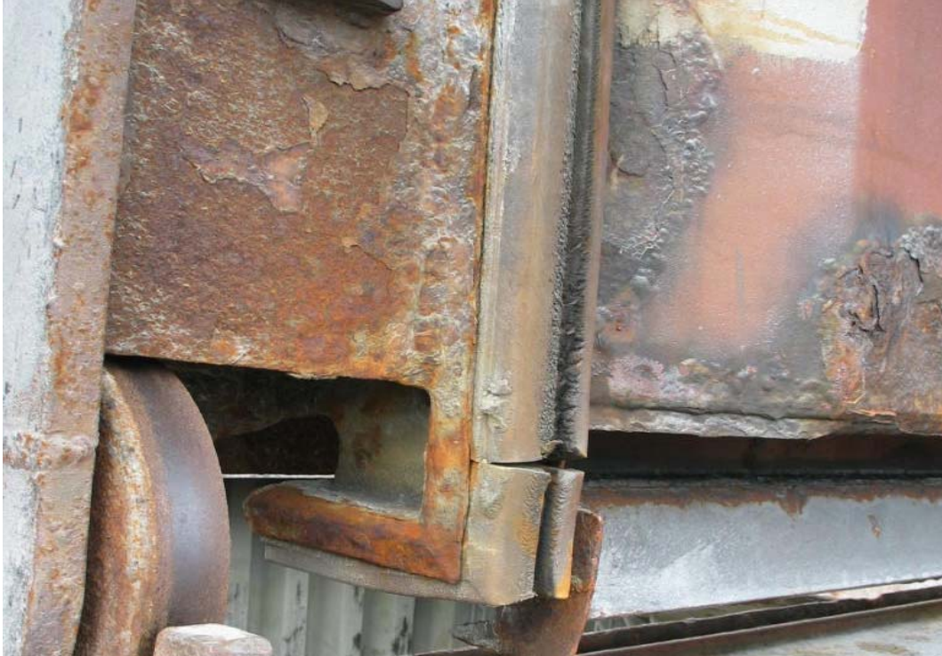
Kuva 6. Tiiviste on halki ja luukkujen alapinnoilla on ruostetta
