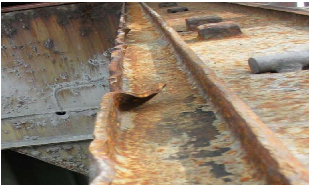
Kuva 3. Kahmarivaurio tippakourun listassa
