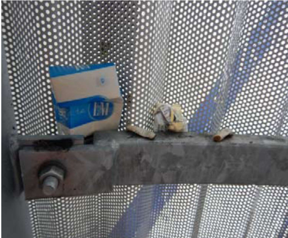
Kuva 5. Ulkopuolinen teräsporras, jonka siivouksesta aiheutuu kustannuksia tuntitöiden muodossa. Kuva: Konstantin Oikonomides.
