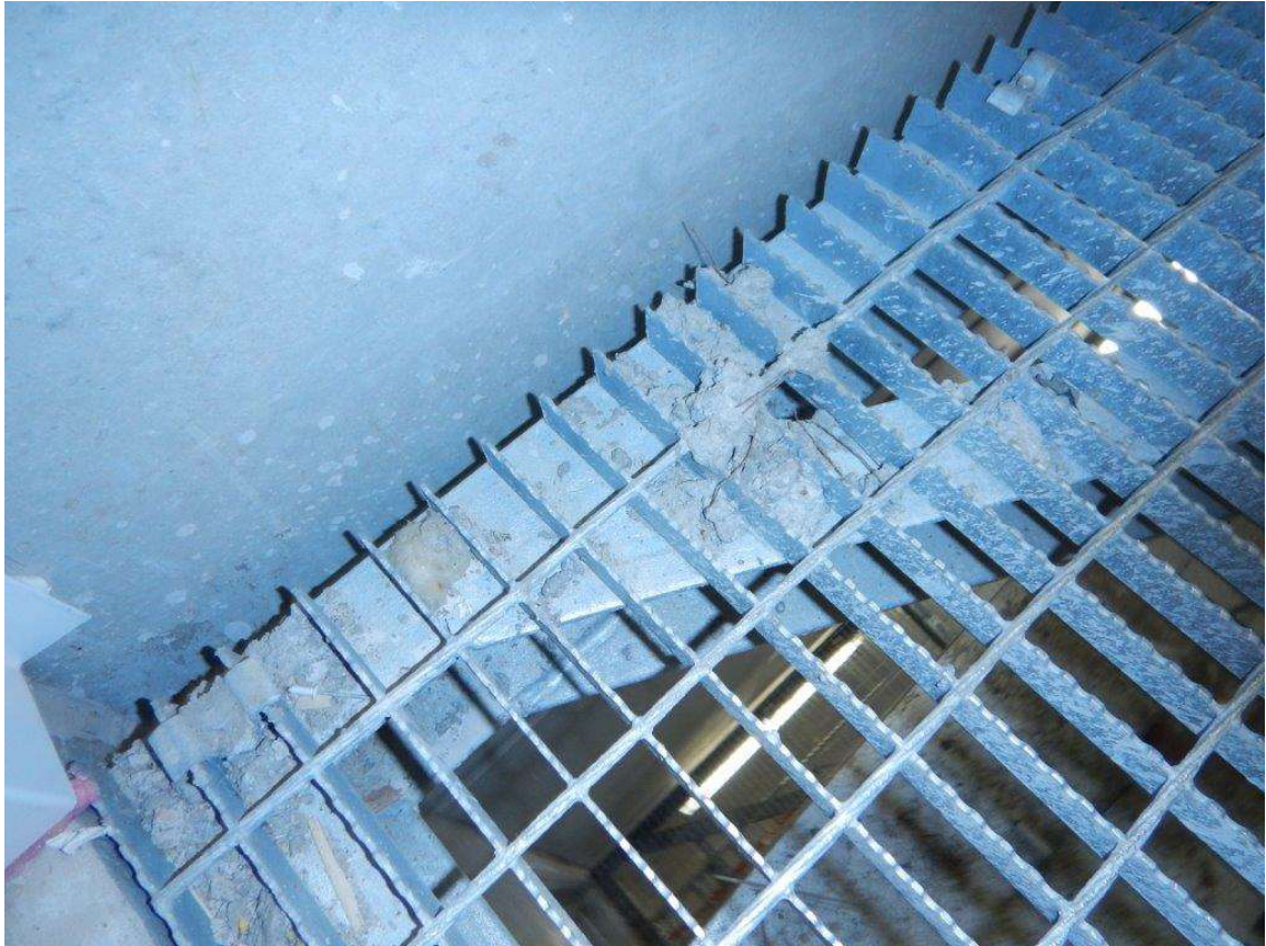
Kuva 3. Betonikokkareita, jotka eivät kuulu loppusiivousurakkaan, ulkopuolisella teräsportaalla. Kuva: Virpi Kilpeläinen.
